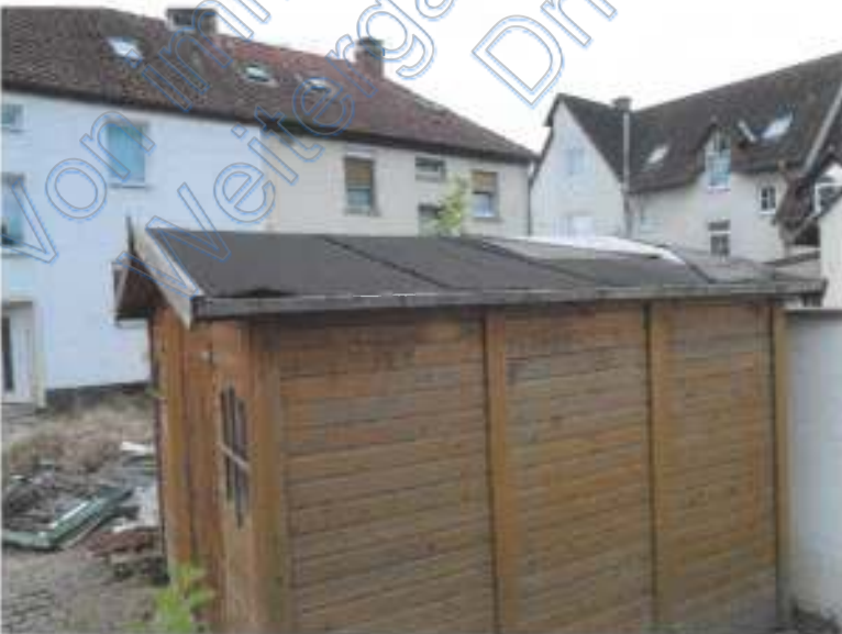
Schäden Dach Geräteschuppen
