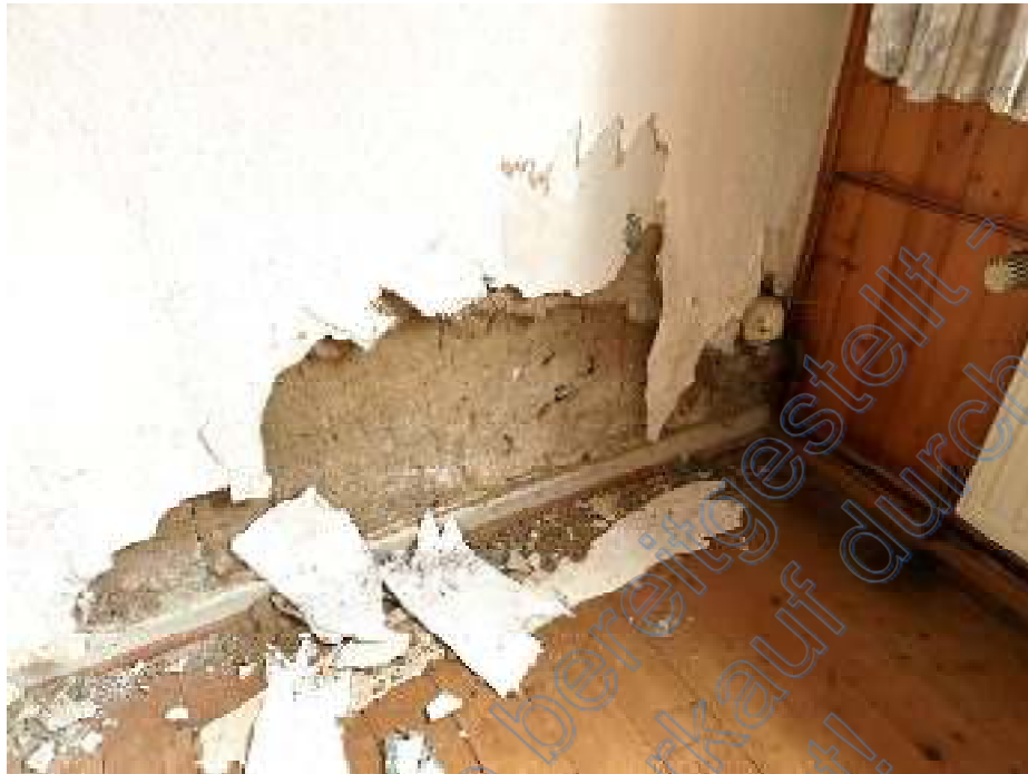
Foto 22: Wohn- und Wirtschaftsgebäude, Feuchtigkeitsschaden im Wohnzimmer aufgenommen am 06.12.2024
