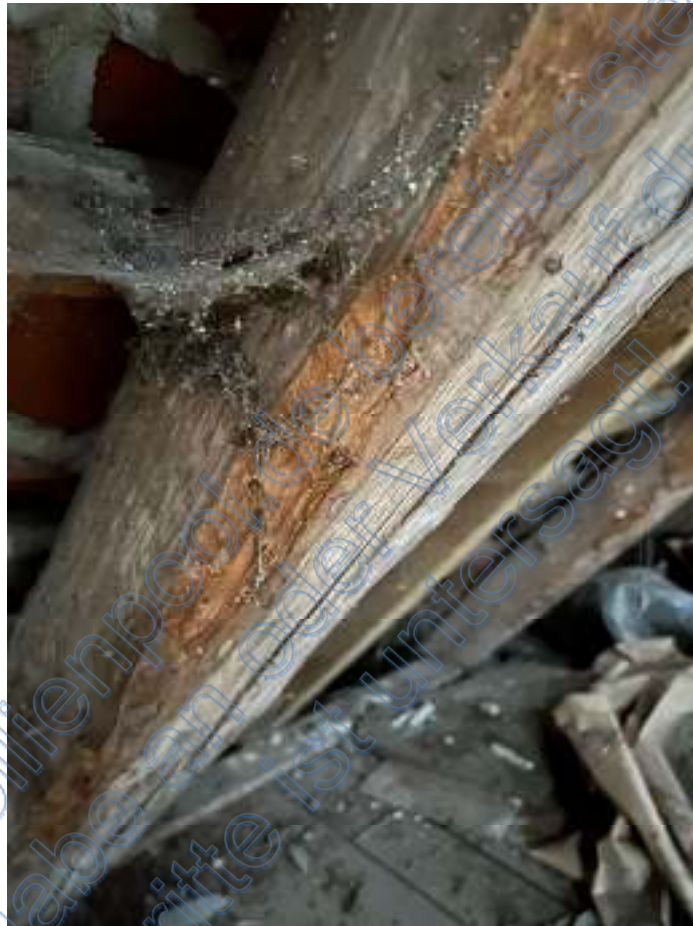
Foto 18: Wohn- und Wirtschaftsgebäude, Holzkonstruktion des Daches mit Schäden durch Holzschädlinge aufgenommen am 06.12.2024
