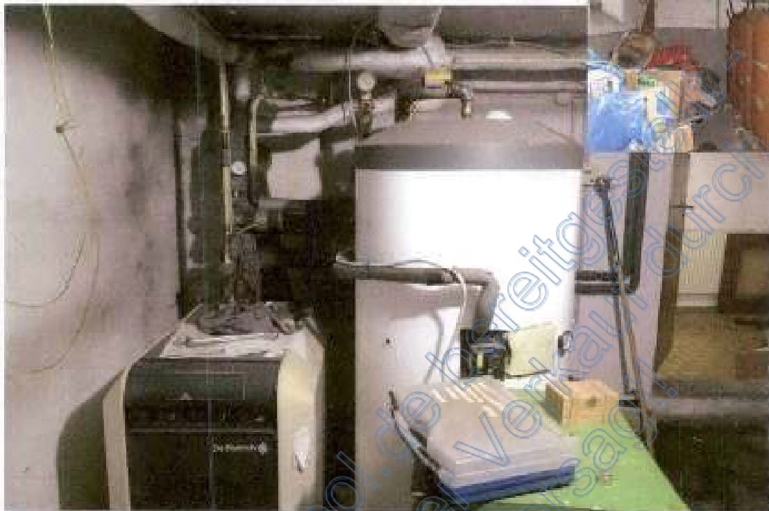
Foto 33, Kellergeschoss, Heizungsraum mit Ölzentralheizungskessel und Warmwasserspeicher, kleines Foto Tankraum mit 4 x 2.000 l Heizöltanks
