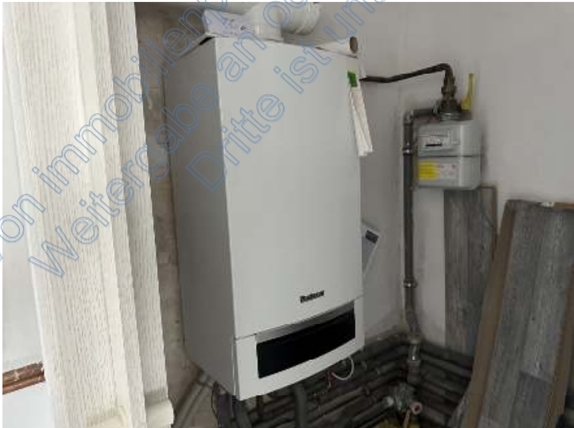
Bild 14: Ausschnitt – Therme im Heizungsraum (südliche Doppelhaushälfte Wohnung 1 EG).
