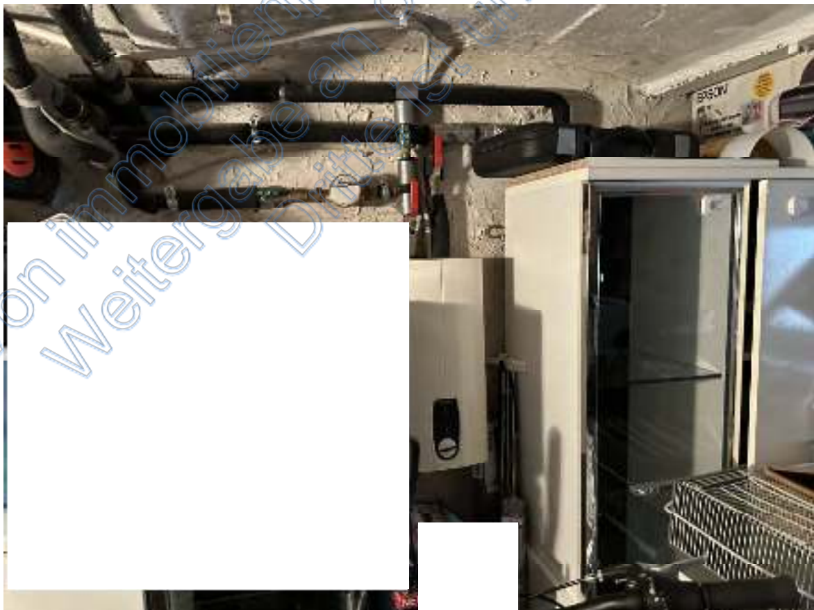
Bild 22: Ausschnitt – Durchlauferhitzer für das Bad
