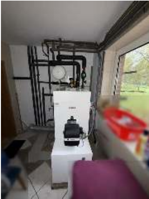
Bild 7: Heizungsraum im Anbau Wirtschaftsgebäude
