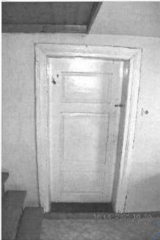
Nicht zeitgemäße Zimmertür
