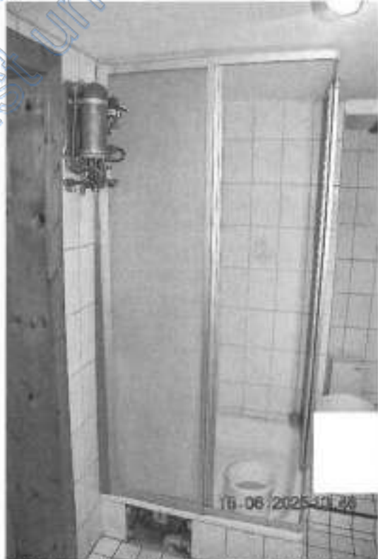
Defekter Durchlauferhitzer Bad Obergeschoss
