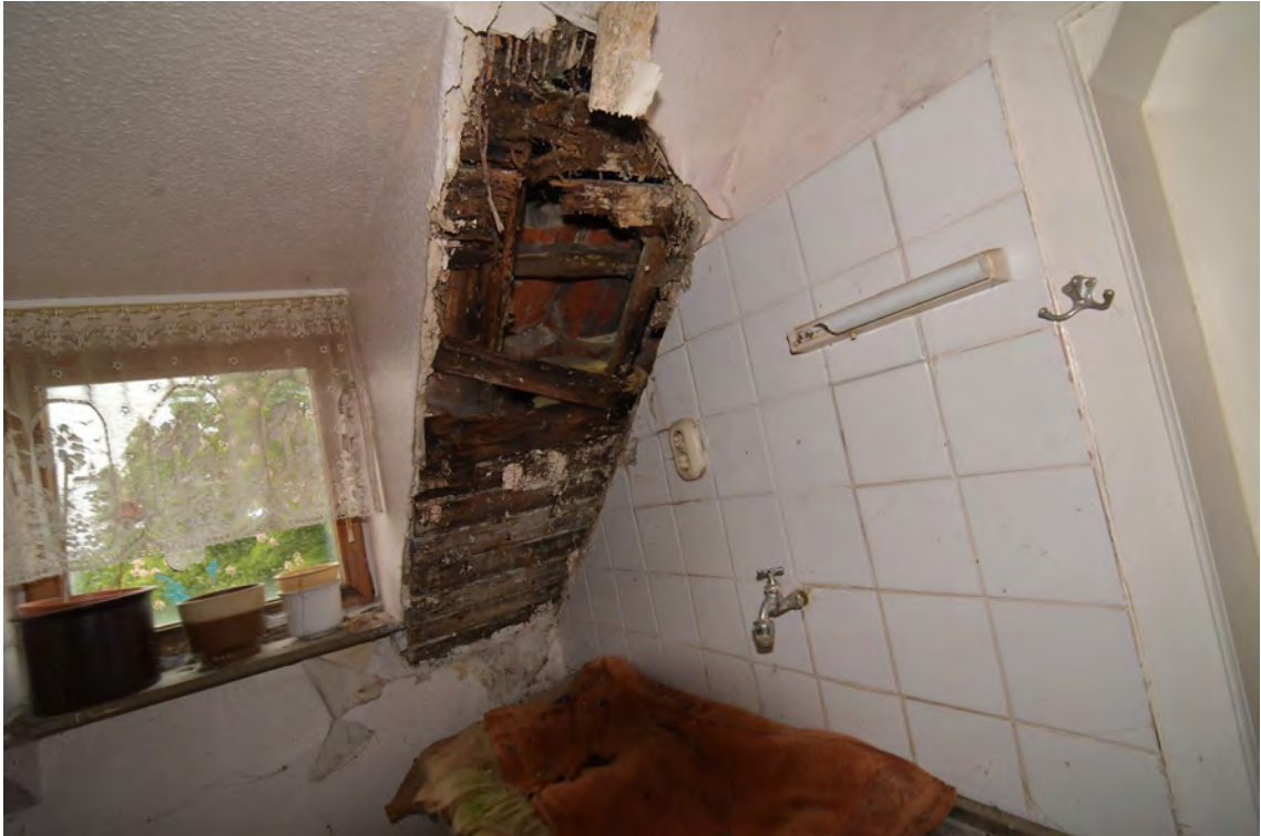
Küche im Dachgeschoss mit feuchtegeschädigter Dachkonstruktion
