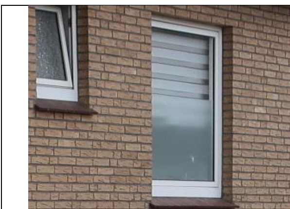
Ansicht defekte Glasscheibe
