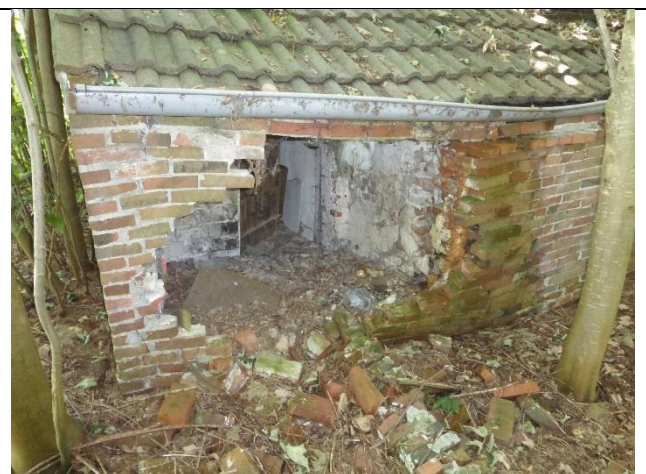
Ansicht Mauerwerksschaden Nordostseite
