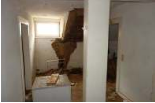
Dachschrägen/ Schaden; OG, Raum 9
