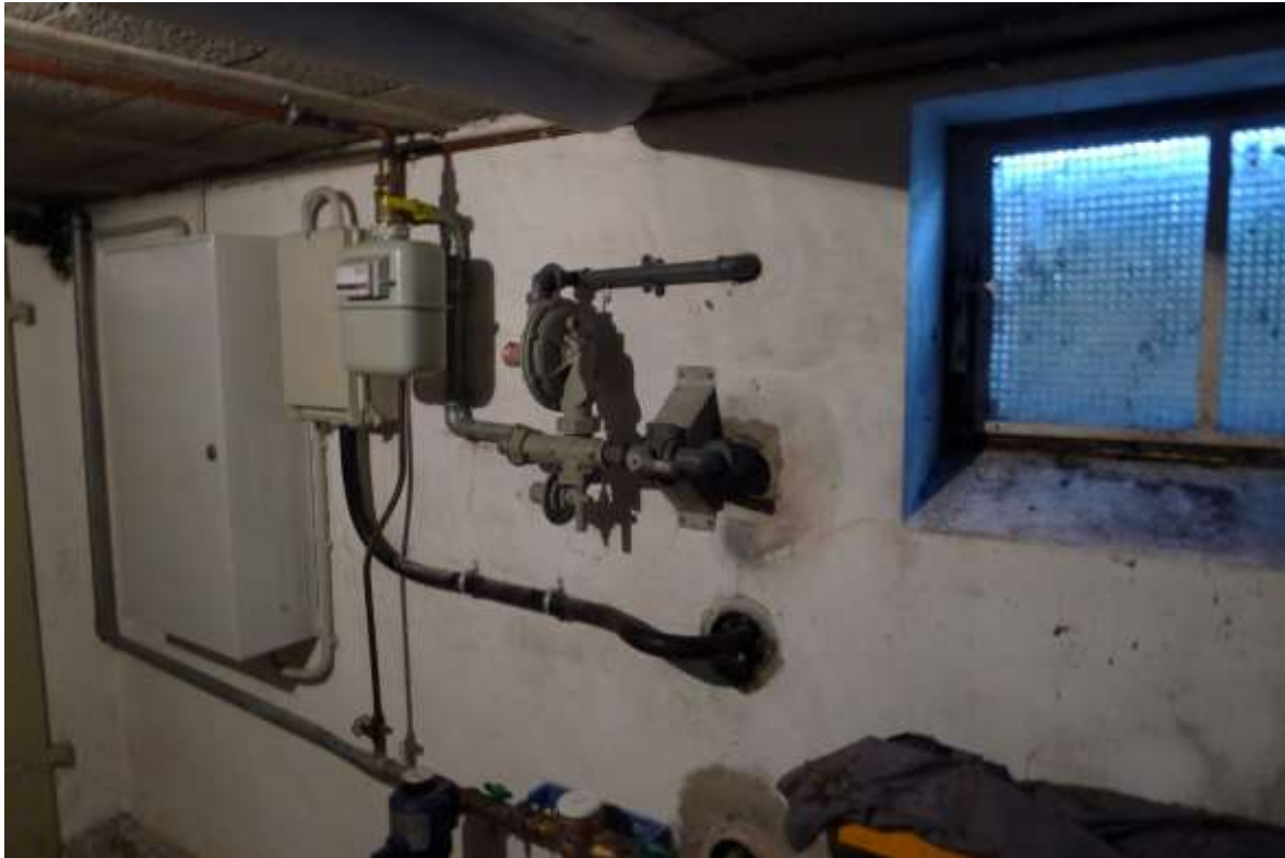
- Kellerraum mit Hausanschlüssen -
