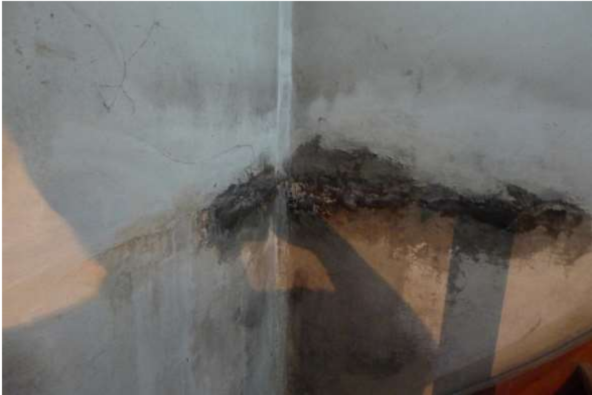
- Kellerraum mit Feuchtigkeitsschaden -
