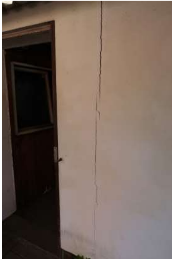
- Nebengebäude Riss in Wand -
