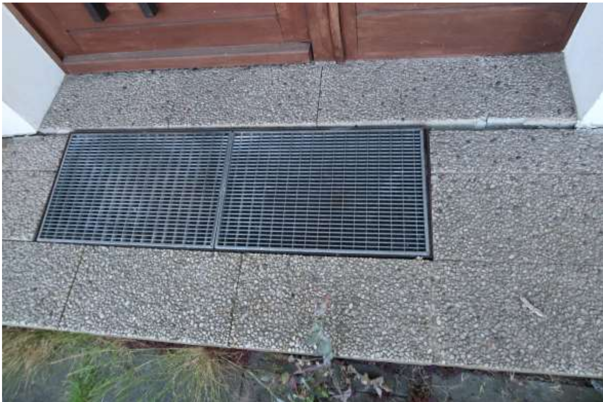
- Wohnhaus abgesacktes Eingangspodest -
