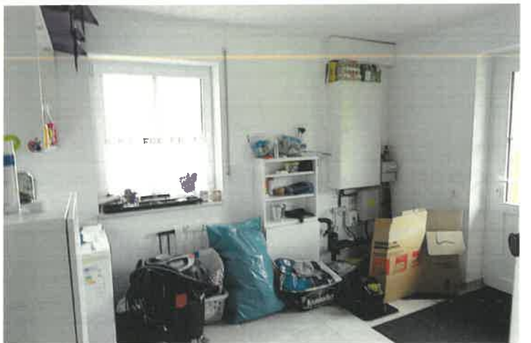
Ansicht des Hauswirtschaftsraumes, in dem sich die Heizung befindet. Ferner gelangt man von hier in den Garten.
