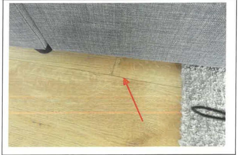
Wasserschaden am Laminat:
