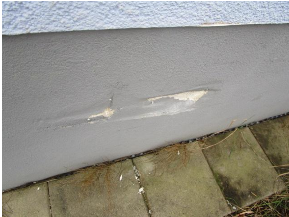
13) Rammschäden im Bereich der Außenfassade
