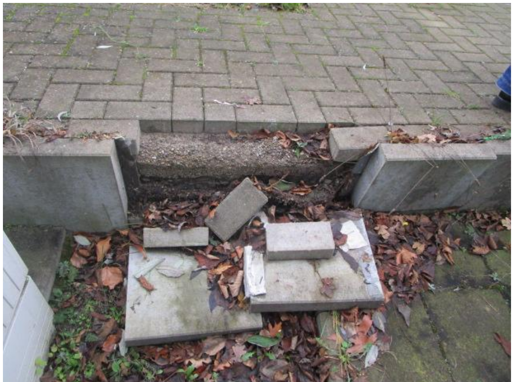
12) Plasterungen mit Beschädigungen
