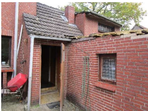
Schaden am Nebengebäude
