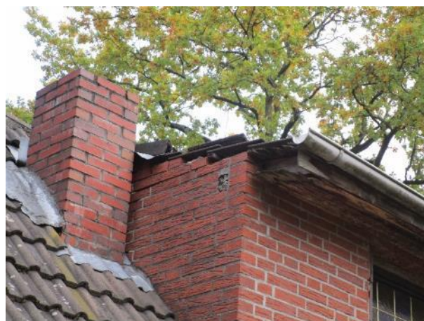
Schaden am Nebengebäude
