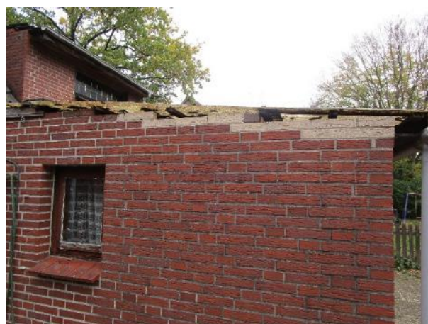
Schaden am Nebengebäude
