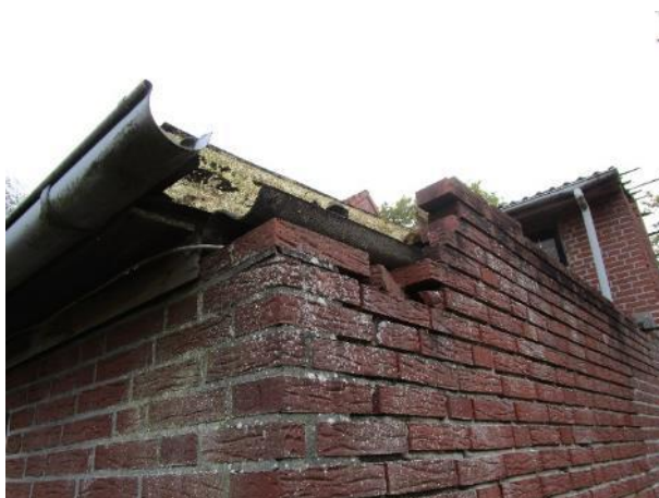
Schaden am Nebengebäude
