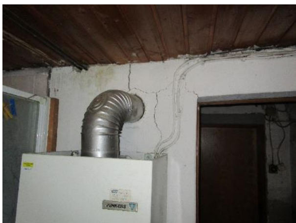
Riss im Mauerwerk (Bad)
