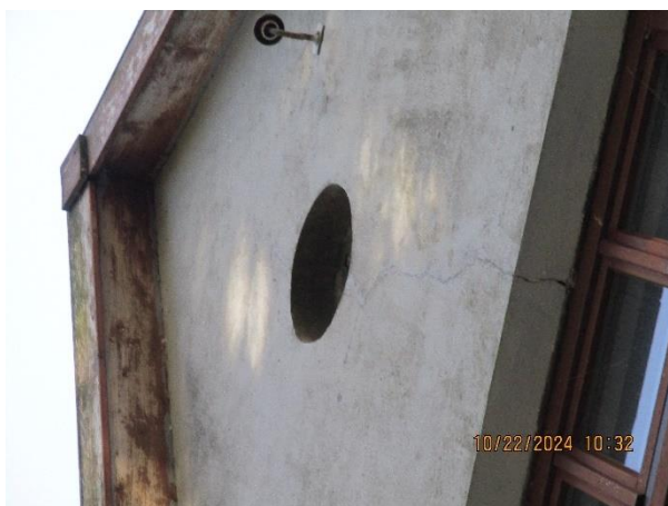
erforderlicher Anstrich / Mauerwerksrisse
