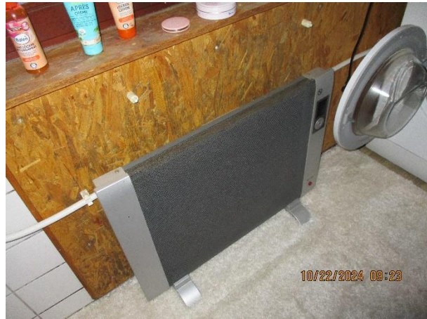
elektr. Heizkörper Bad
