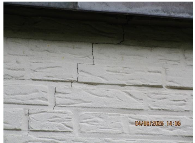
Riss im Außenmauerwerk
