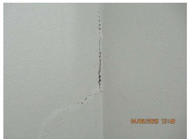
Riss im Mauerwerk
