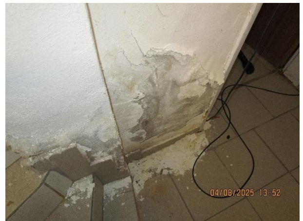
Feuchtschäden/Schimmel im Keller
