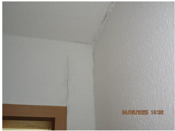
Riss im Mauerwerk
