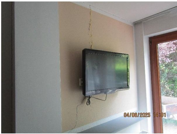
Riss im Mauerwerk
