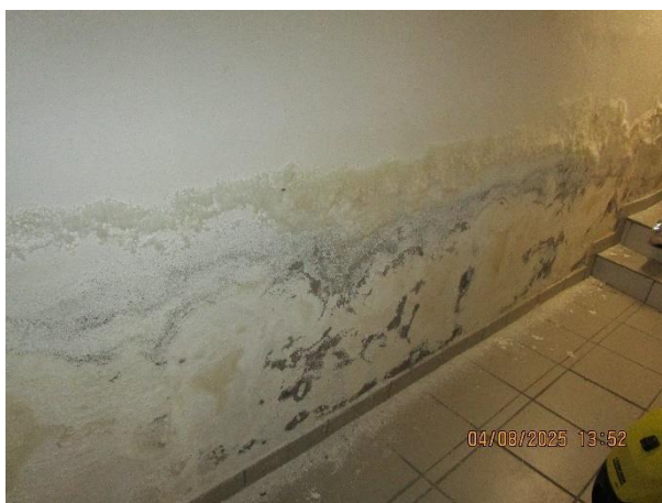
Feuchtschäden/Schimmel im Keller
