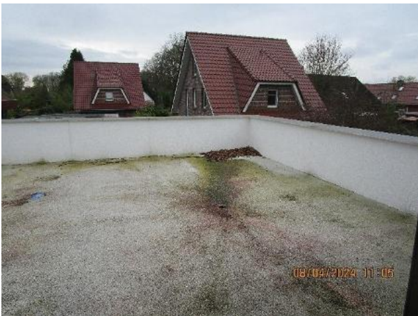
Dachterrasse – Bodenaufbau ist zu überprüfen
