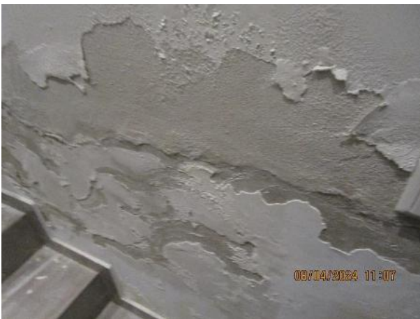
Wasserschaden im Keller
