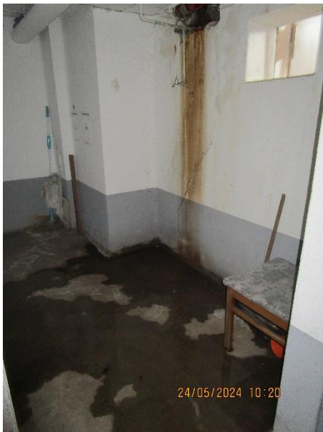
Feuchtigkeit im Geräteraum
