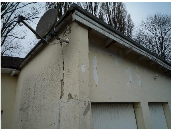
Risse u. Putzabplatzungen Außenmauerwerk
