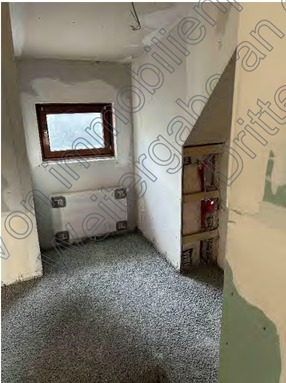
Foto 38 Gaube zum Garten bauaufsichtlich nicht genehmigt
