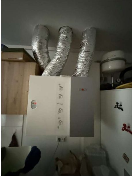
Lüftungsanlage mit Wärmerückgewinnung
