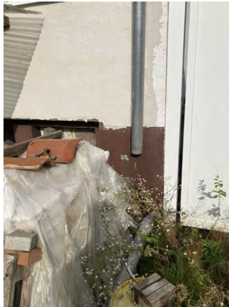
fehlender Anschluss Fallrohr
