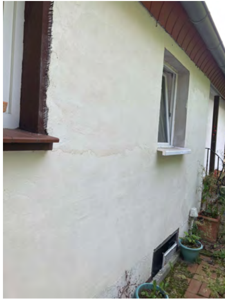
mangelhafte Verputzung Fensterlaibung
