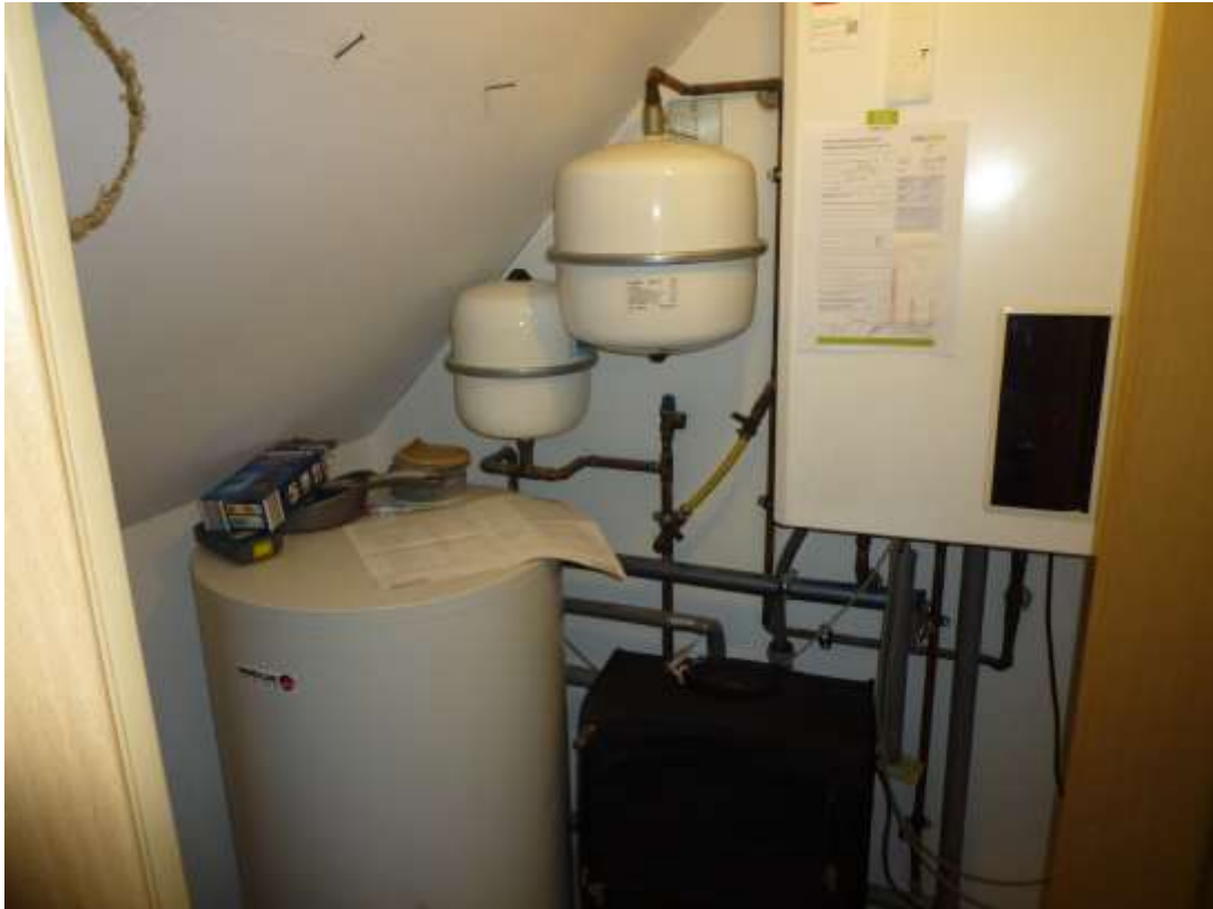
Heizung im Dachgeschoss der Garage
