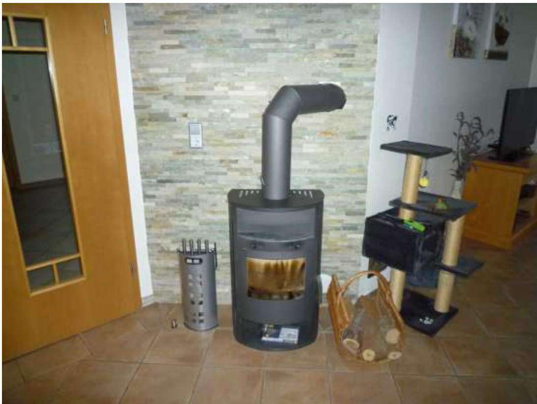
Kaminofen im Wohnzimmer (Zeitwert überschritten)
