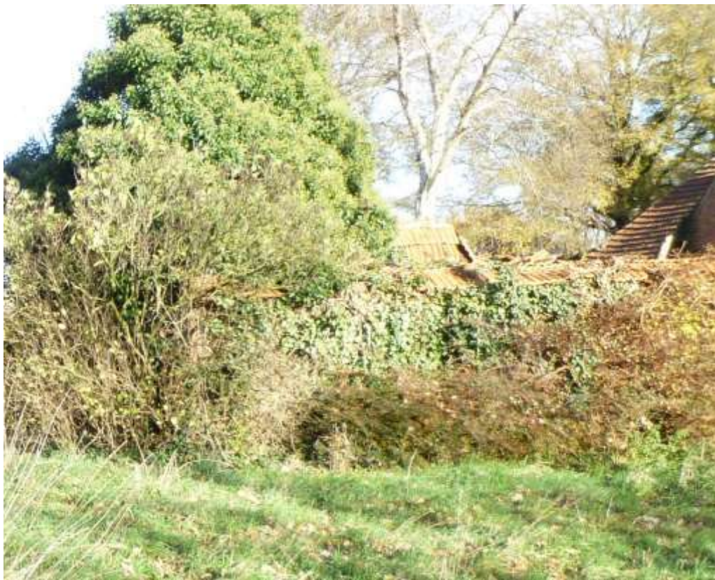
eh. Schweinestall (ca. 1910) / abbruchreif / Ansicht aus südlicher Richtung
