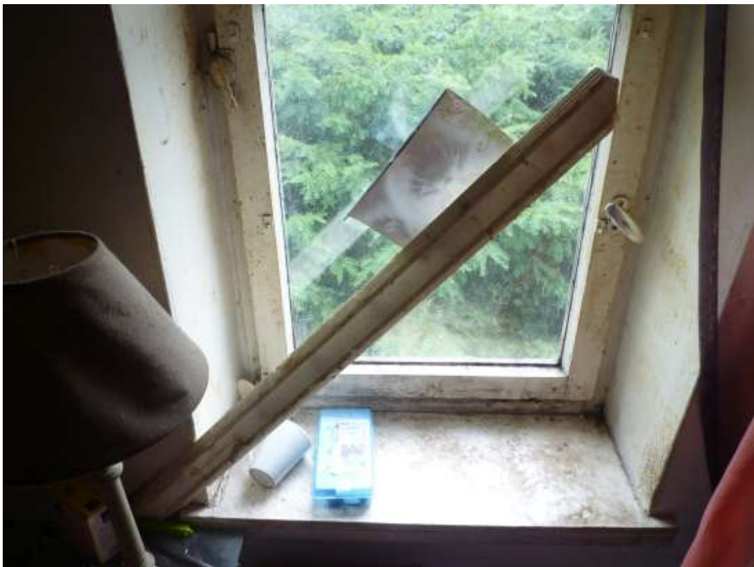
Zustand Fenster (Beispiel)
