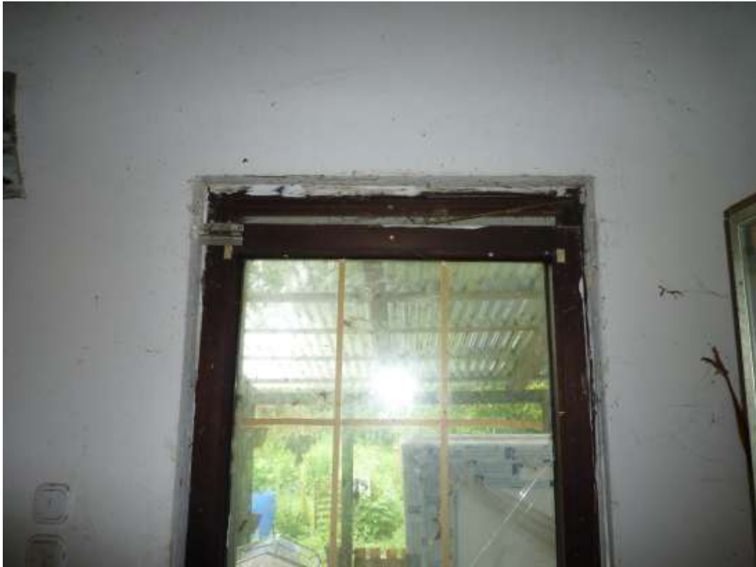
Zustand Terrassentür / die Tür lehnt nur an den Rahmen (nicht mehr fest verbaut)
