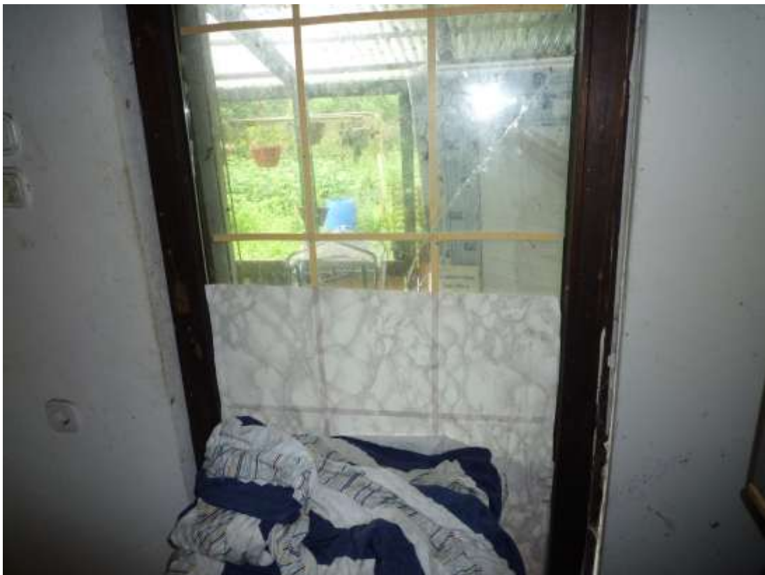
Zustand Terrassentür / die Tür lehnt nur am Rahmen (nicht mehr fest verbaut)
