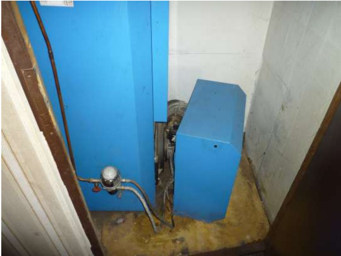
Zustand Ölheizung / die Funktion wird als eingeschränkt eingestuft
