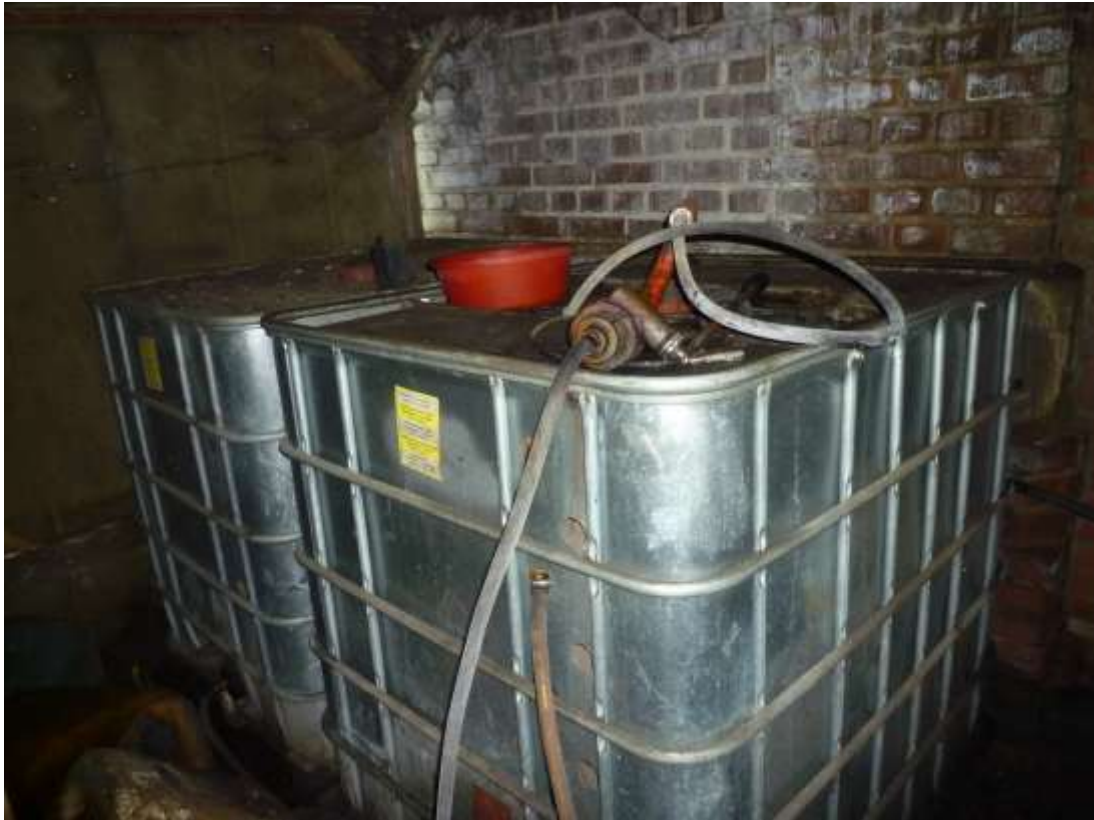
improvisierte Öltanks in einem kleinen Schuppen am Wohnhaus / rechtliche Zulassung ist fraglich
