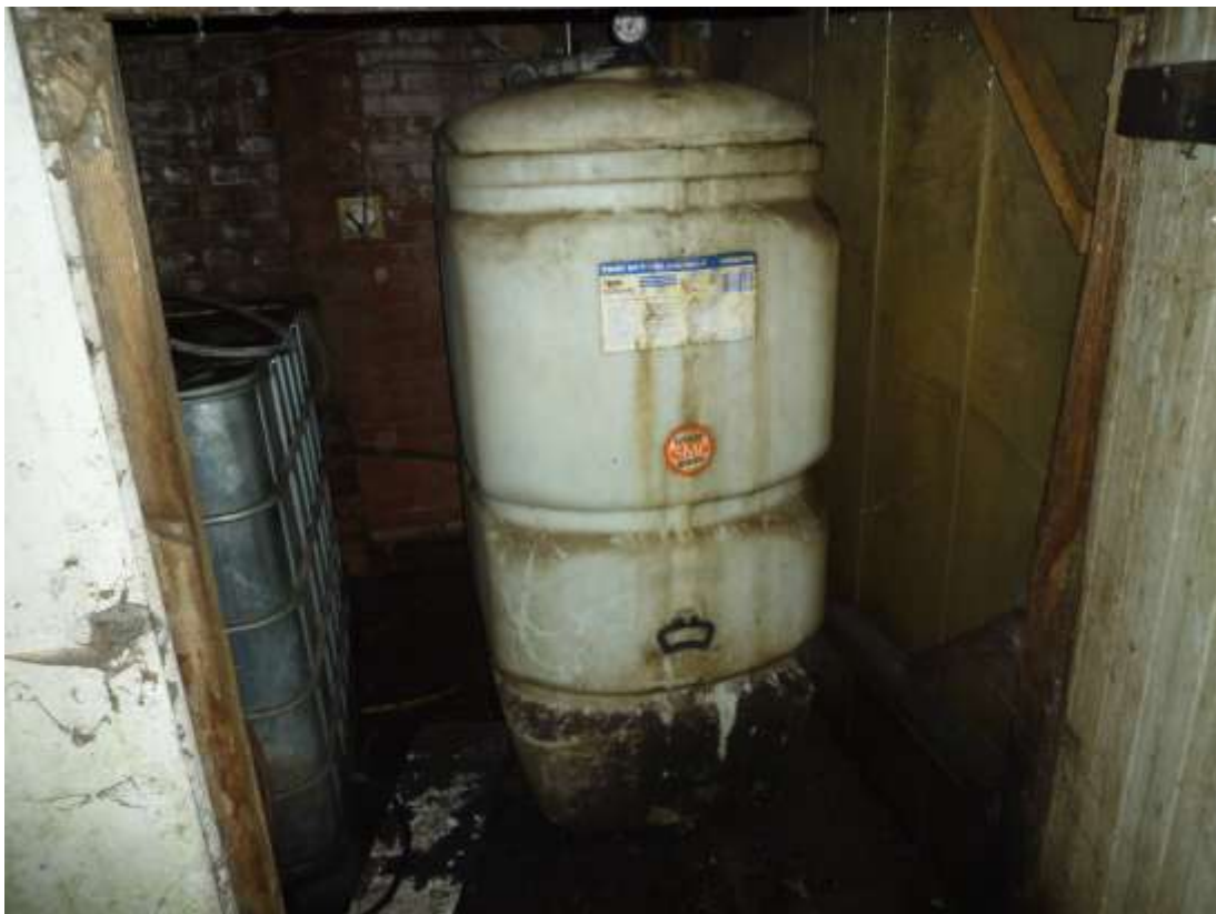
Öltank in einem kleinen Schuppen am Wohnhaus
