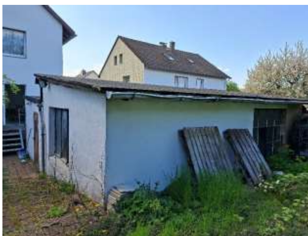
Bereich um den nicht genehmigten Garagenanbau
