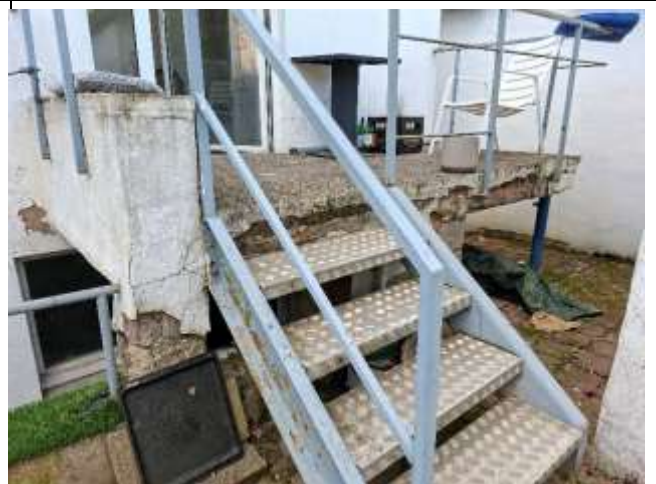
Balkon vor der Küche mit erheblichen Schäden an der Balkonplatte / Mauerwerk / Gründung
