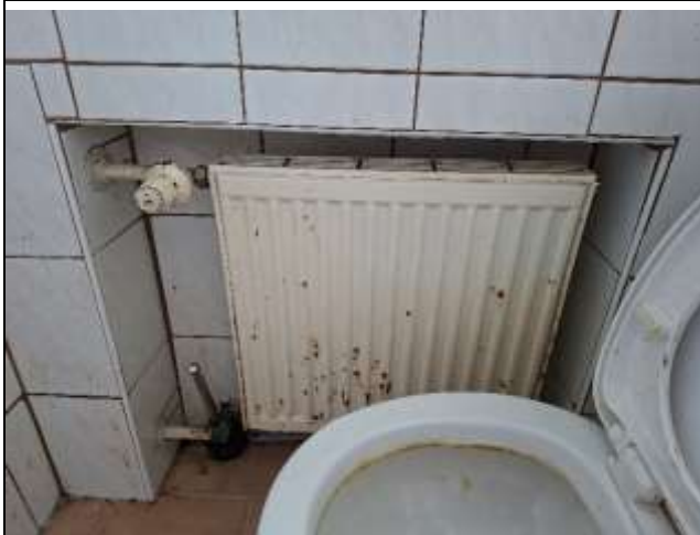
Rostflecken am Heizkörper im WC
