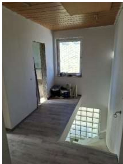
Treppenloch ohne Geländer
