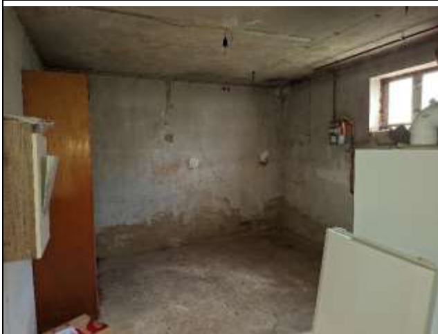
Kellerraum mit Putzschäden
