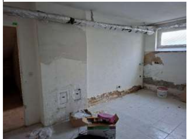
Kellerraum mit Putzschäden an den Wandsockeln aufgrund von Feuchtigkeitseinwirkung
