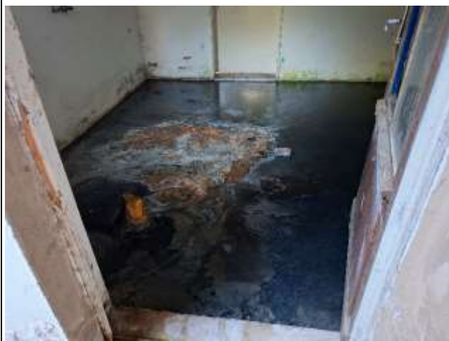
Kellerraum zur Kelleraußentreppe, welcher bis zur Türschwelle mit fäkalienhaltigem Abwasser vollgelaufen ist
