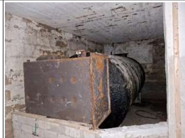
Öllager unter Wintergarten / Terrasse mit nassen Wänden und Decken sowie Putzschäden an diesen
