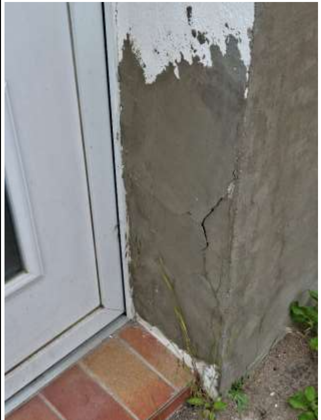
Risse im Putz neben der Hauseingangstür
