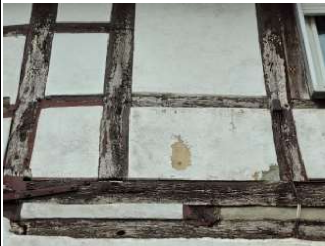
Abblätternder Altanstrich der Gefachhölzer
