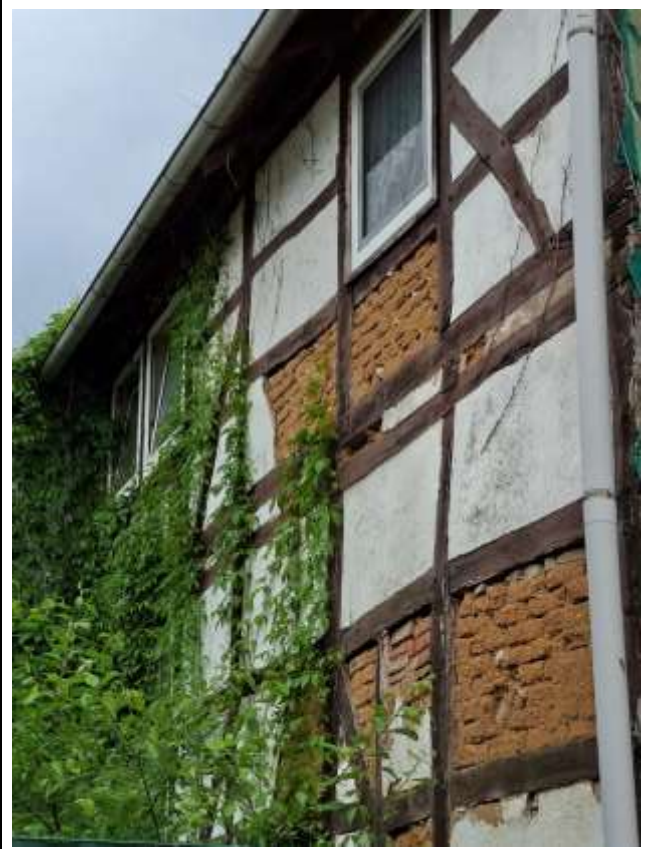
Gefache mit fehlendem Putz an der nördlichen Wohnhausseite
