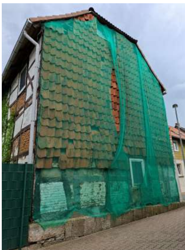
Westlicher Giebel mit Netz nach baubehördlicher Anordnung zur Sicherung der nachbarlichen Hoffläche vor herabfallenden Fassadenteilen
