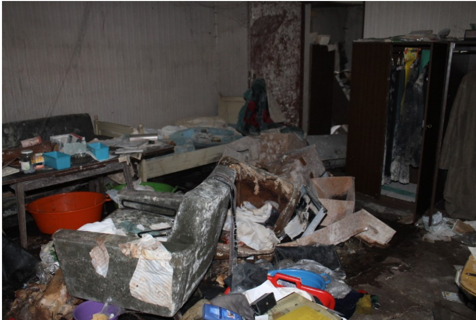
Mit Schimmelsporen durchzogener Hausrat
