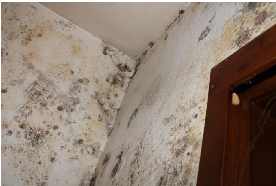
Mit Schimmelsporen durchzogene Wand- und Deckenkonstruktion
