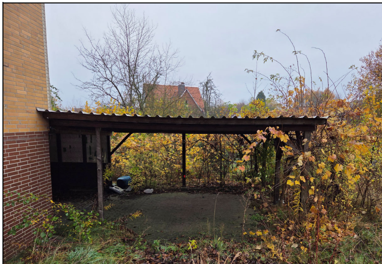
Bild 2 oben: Carportanlage. In vorgelegter Bauakte nicht nachgewiesen.
