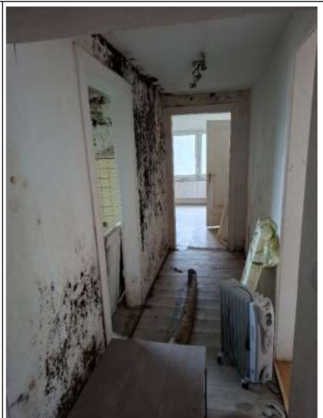
Flur – mit erheblichem Schimmelpilzbefall
