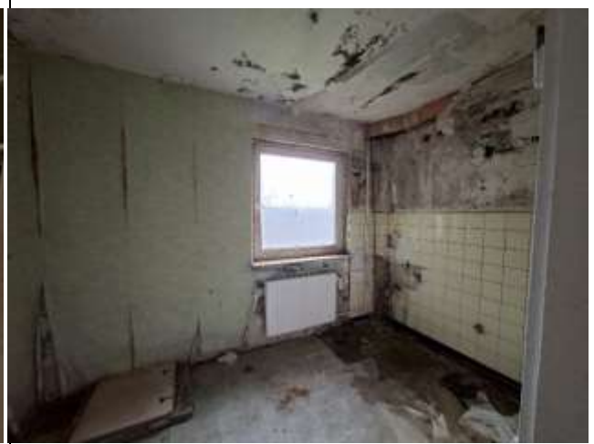
Küche – mit erheblichem Schimmelpilzbefall
