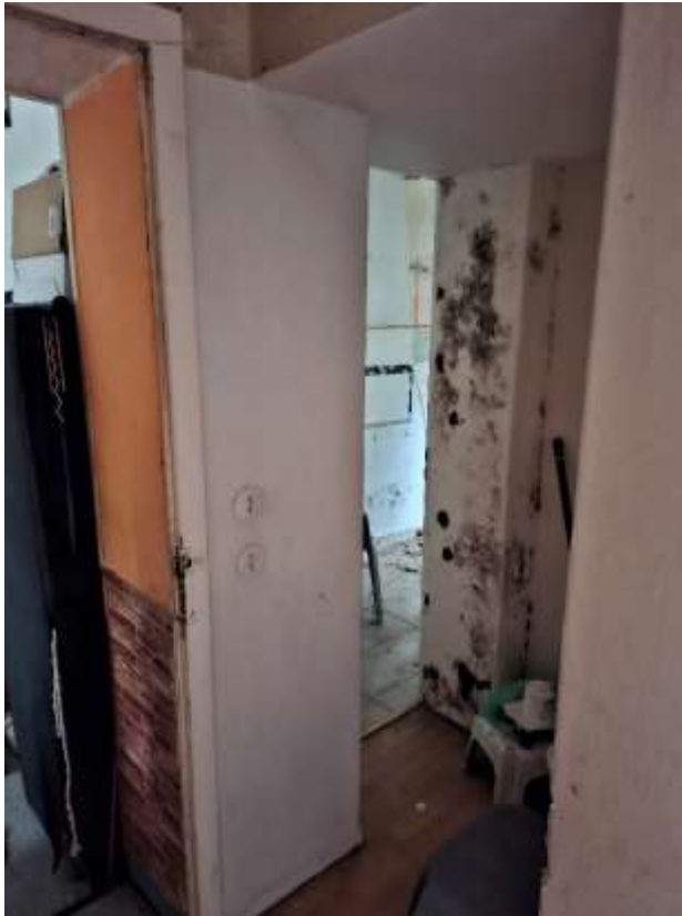
Erheblicher Schimmelpilzbefall an der Wand zum WC
