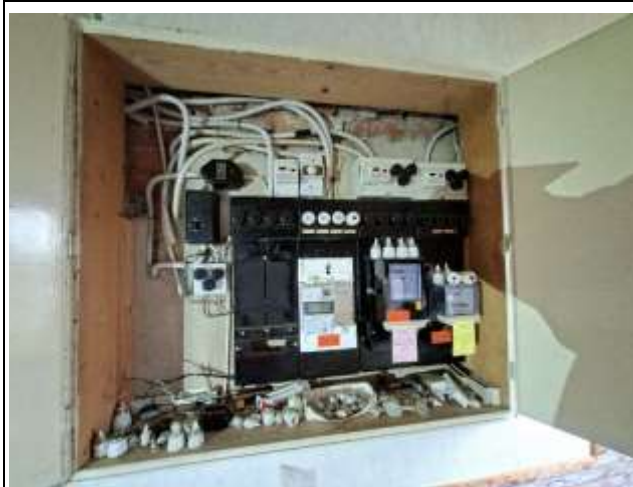
Elektro-Sicherungskasten, welcher nicht den gültigen VDE-Regeln entspricht
