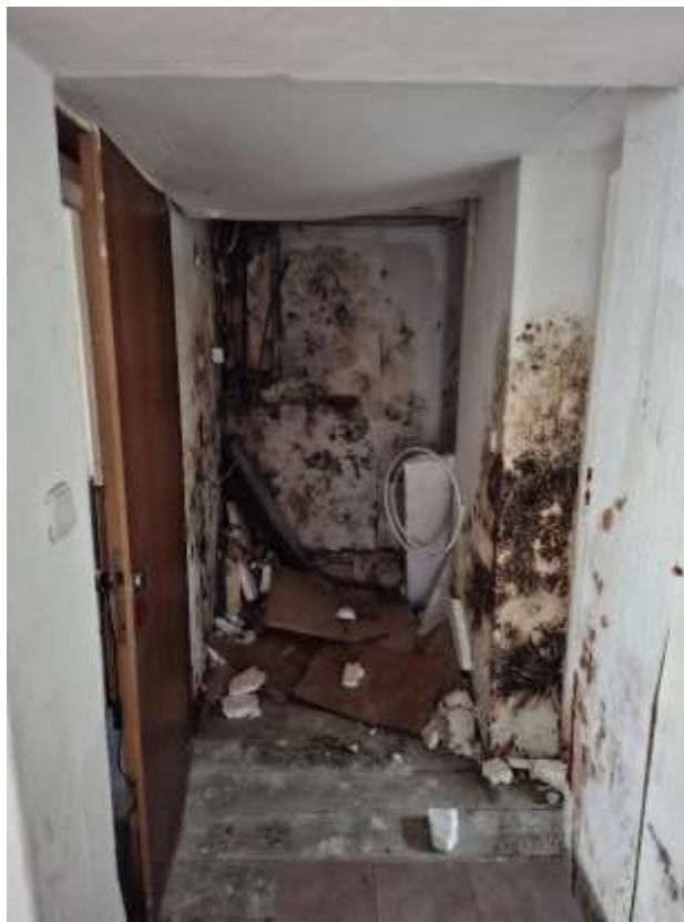
Flur – mit erheblichem Schimmelpilzbefall
