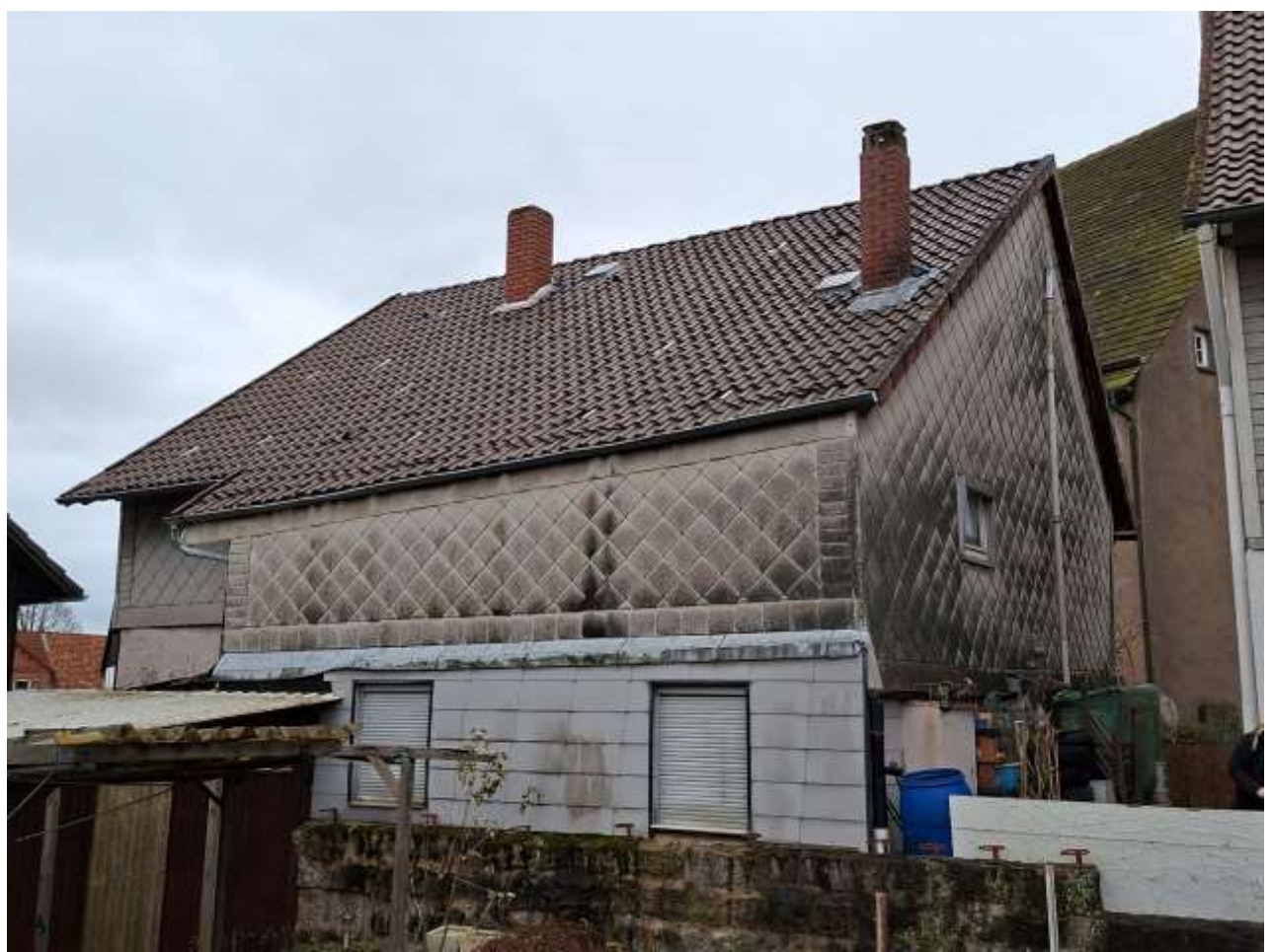
Ansicht von Nord-Westen (Trauf- und Gartenseite) Ansicht von Süd-Westen (Giebel- und Hofseite)
