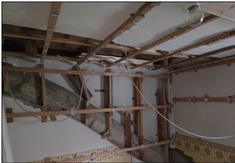
Bild 4 oben: exemplarisch für rohbauähnlichen Zustand im KG.
