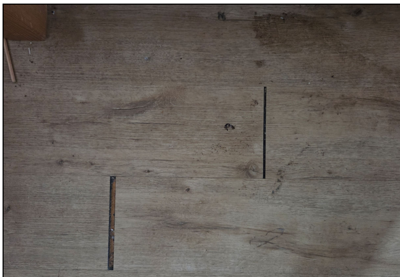
Bild 5 oben: exemplarisch für offene Fugen im Fußbodenbelag
