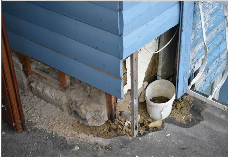
Bild 4 oben: Schäden im Fassadenbereich
