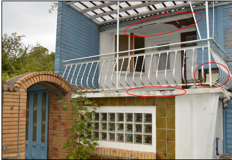
Bild 3 oben: erkennbare Mängel / Schäden am Anbau
