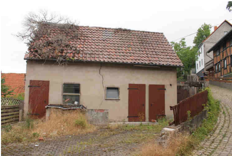
Stallgebäude (Lfd. Nr. 1) aus süd-Östlicher Richtung mit vertikalem Riss in der Traufwand
