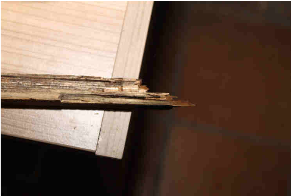
Würfelbruch durch holzzerstörende Pilze an Holzbauteilen
