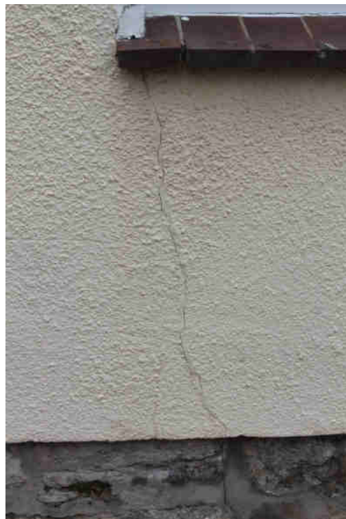
Riss im Sockelbereich der südlichen Giebelwand
