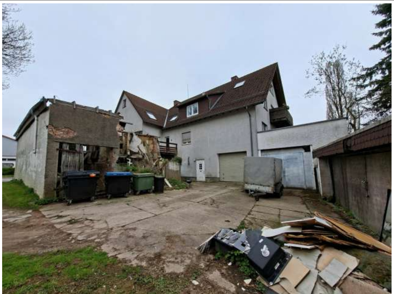
Ansicht der Nordseite (Giebelseite des Vorderhauses und Traufseite des Hinterhauses) und Ansicht des verfallenen Anbaus (links) sowie des Nebengebäudes (rechts)
