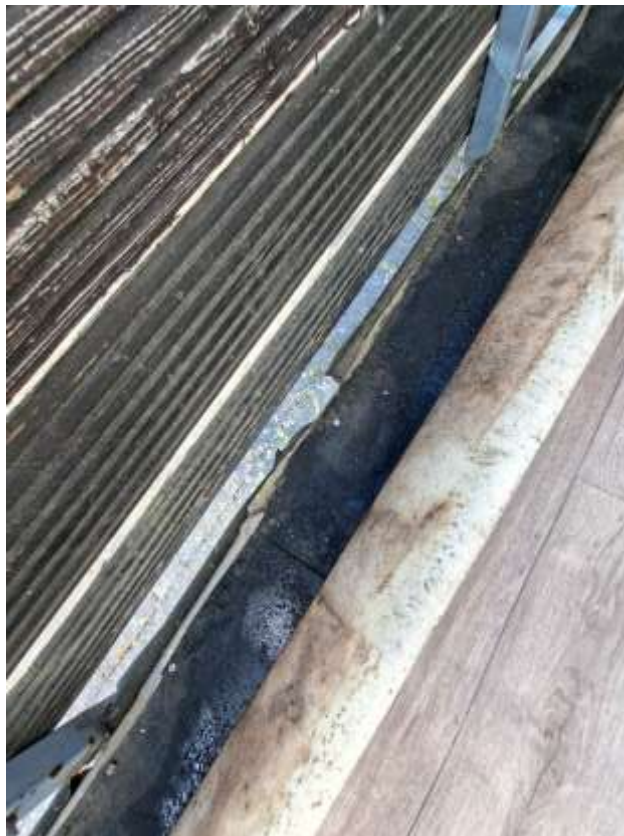
Mangelhafte Balkonabdichtung, PVC-Balkonbelag unterseitig verschimmelt
