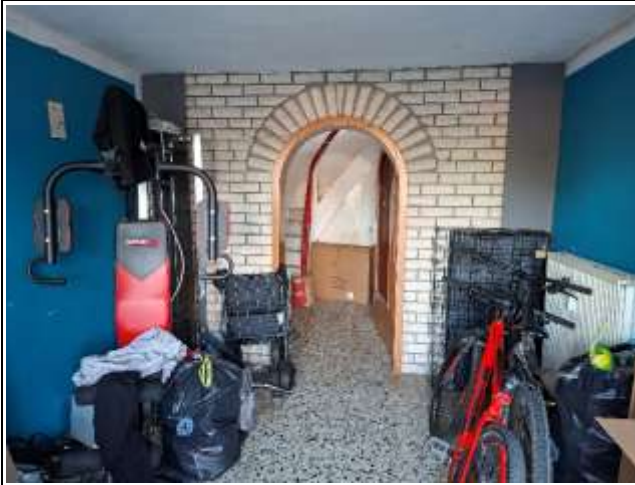
Eingangsbereich im Vorderhaus – Zugang zur genehmigten gewerblichen Einheit (jetzt zwei ungenehmigte Wohneinheiten) und zu Wohnung 1 im Obergeschoss
