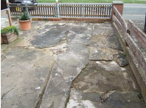
Schadhafter Beton in der Zufahrt zur Garage
