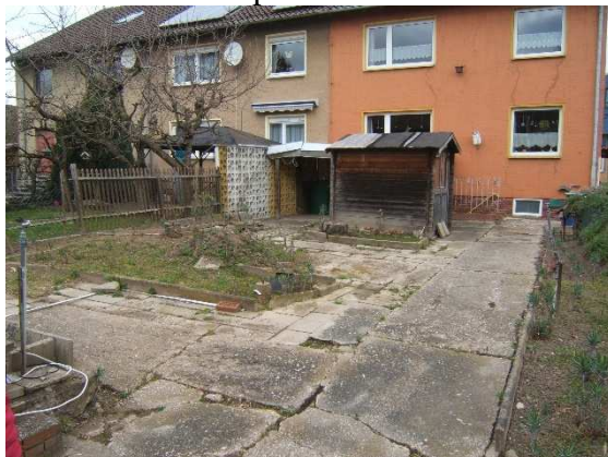
Schadhafte Betonplatten im Garten
