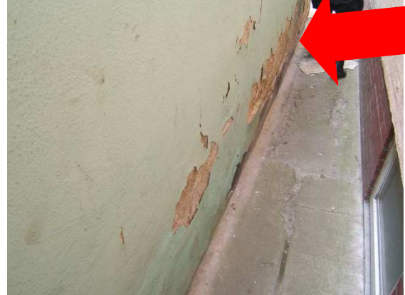
Schadhafter Putz an der Garage
