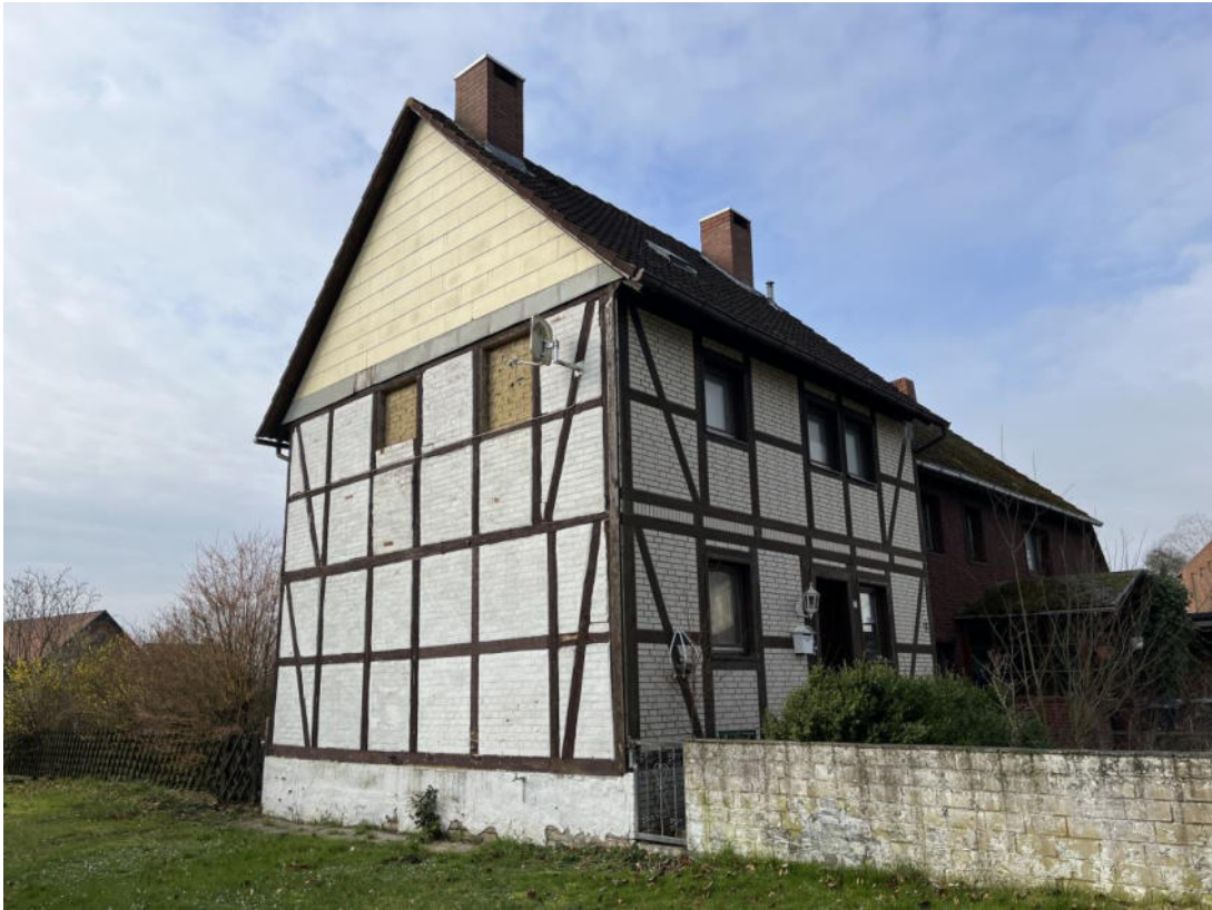
Bild 3: Schäden am Ostgiebel
