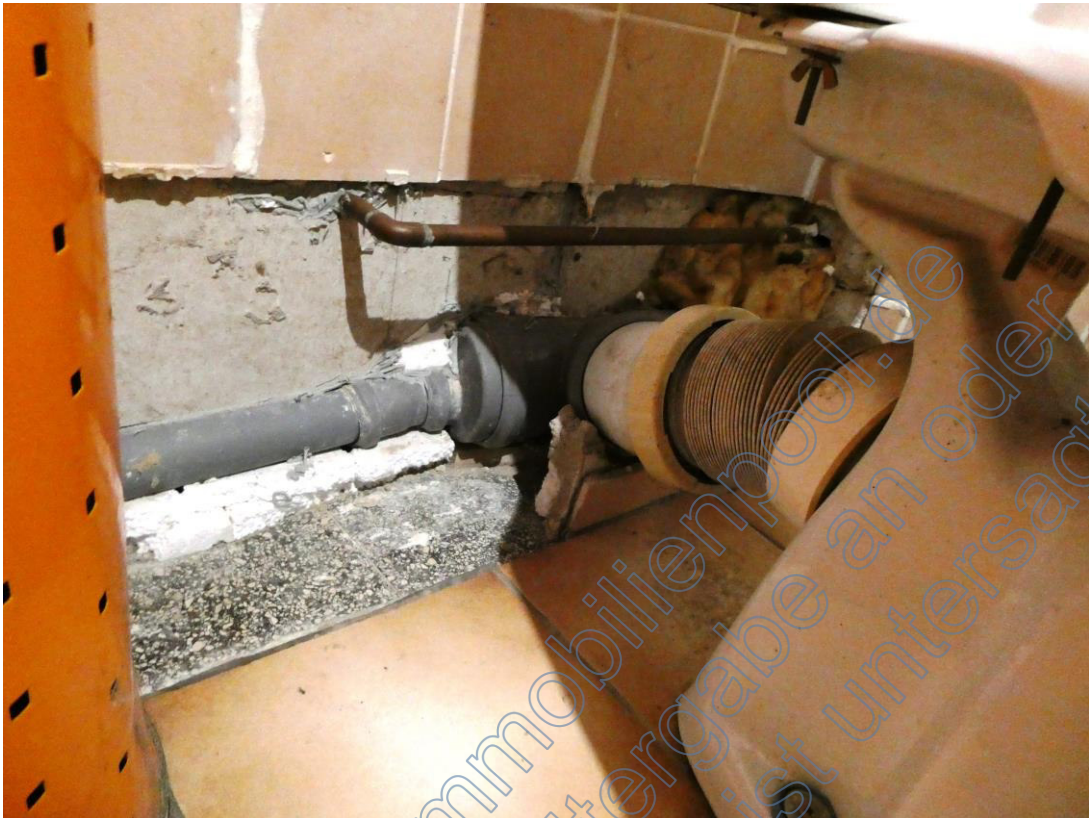
Bild 11: fehlende Fliesen im Bad
