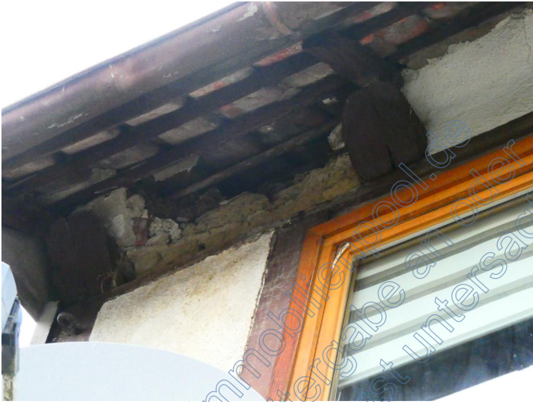
Bild 7: Schaden im Traufbereich
