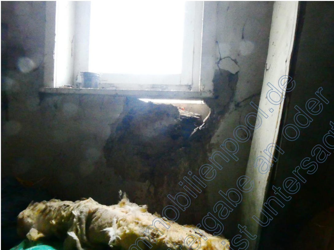
Bild 9: verfallener Brüstungsriegel, Schaden am Gefach
