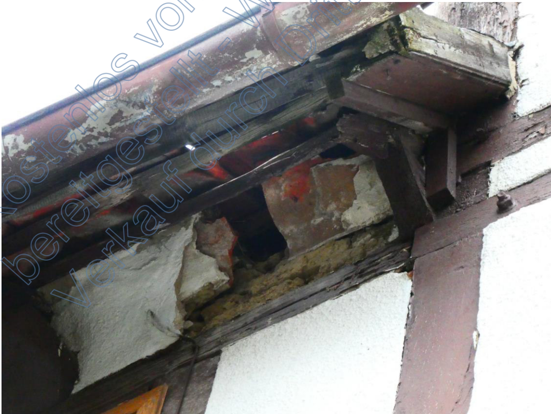
Bild 8: weiterer Schaden im Traufbereich
