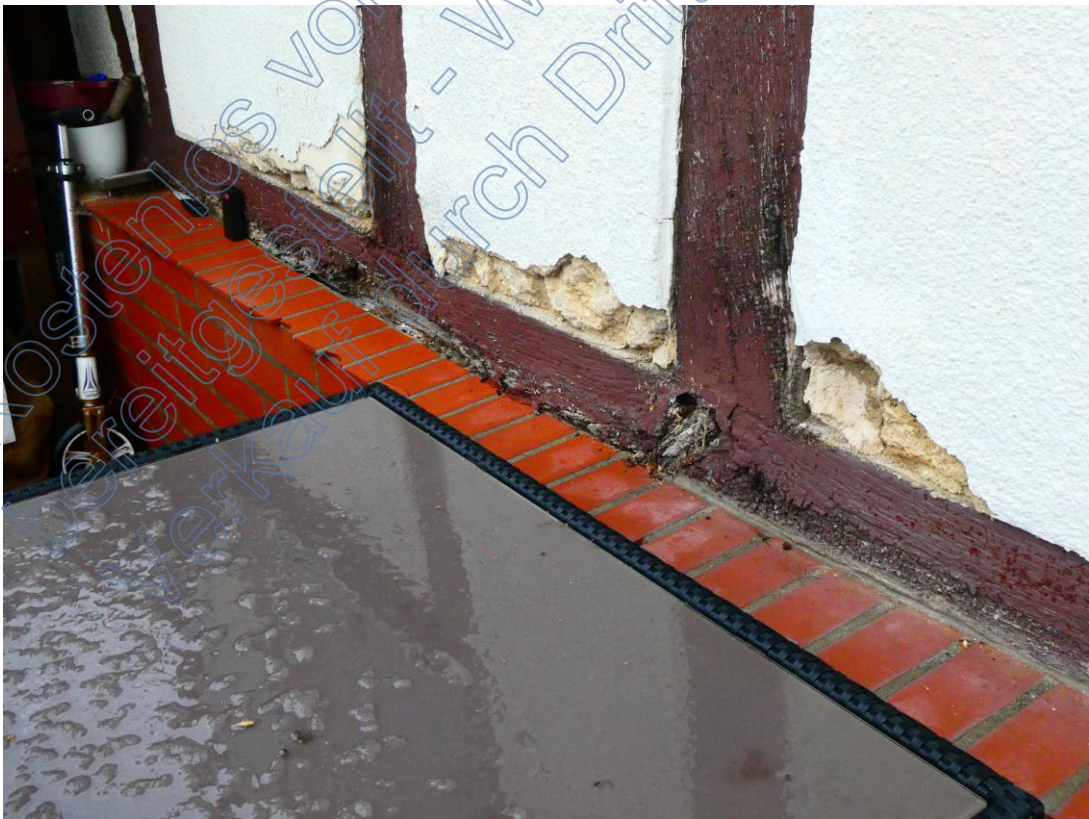
Bild 6: Schäden am Schwellholz und den Gefachen
