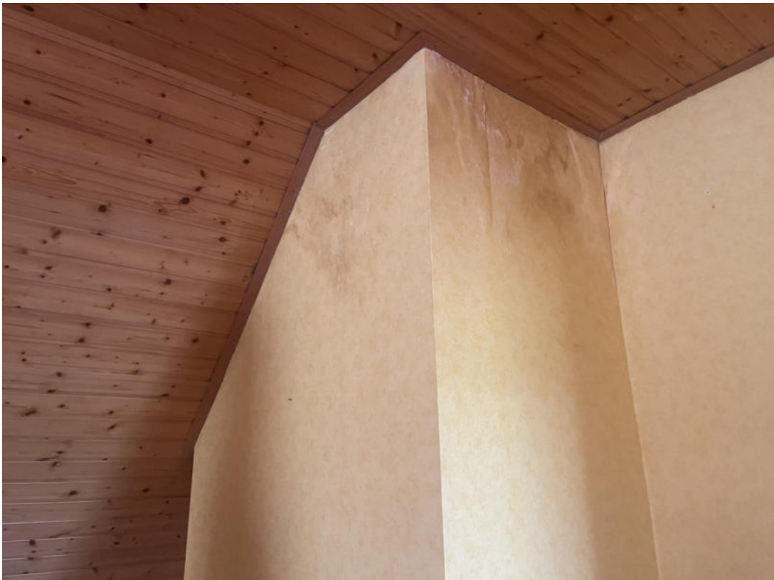
Bild 10: Wasserablaufspuren am Schornstein
