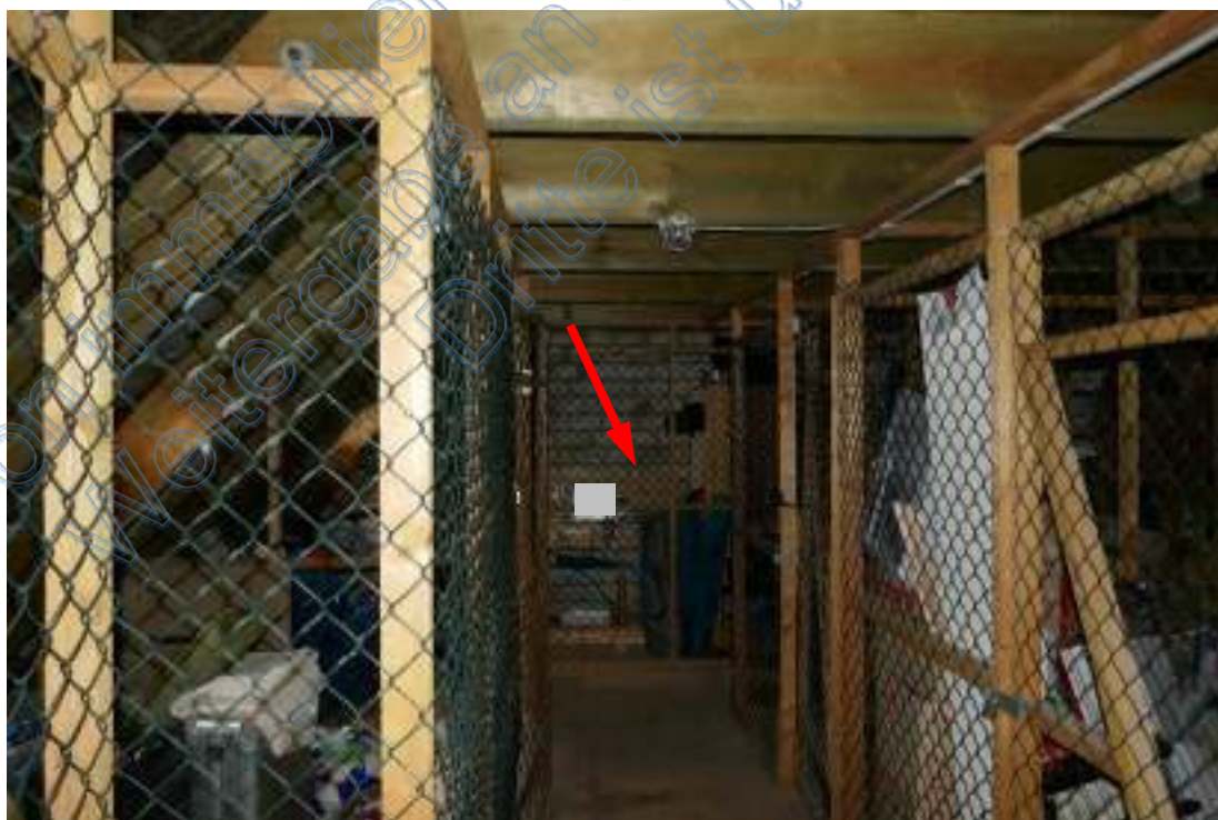
Foto 14, Spitzboden, Abstellräume durch Holzständerwerk, bespannt mit Maschendraht abgetrennt, Pfeil weist zum Abstellraum Nr. 7
