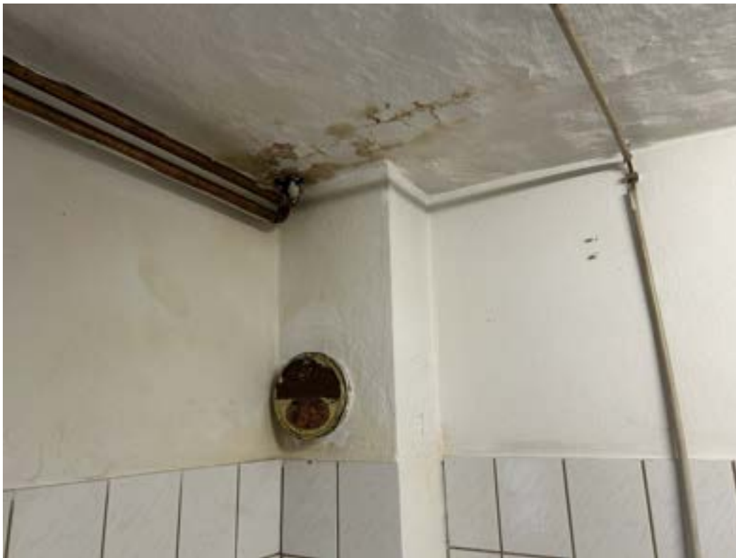
Anlage 5.11: Bild 11 Durchfeuchtung Deckenbereich Waschküche
