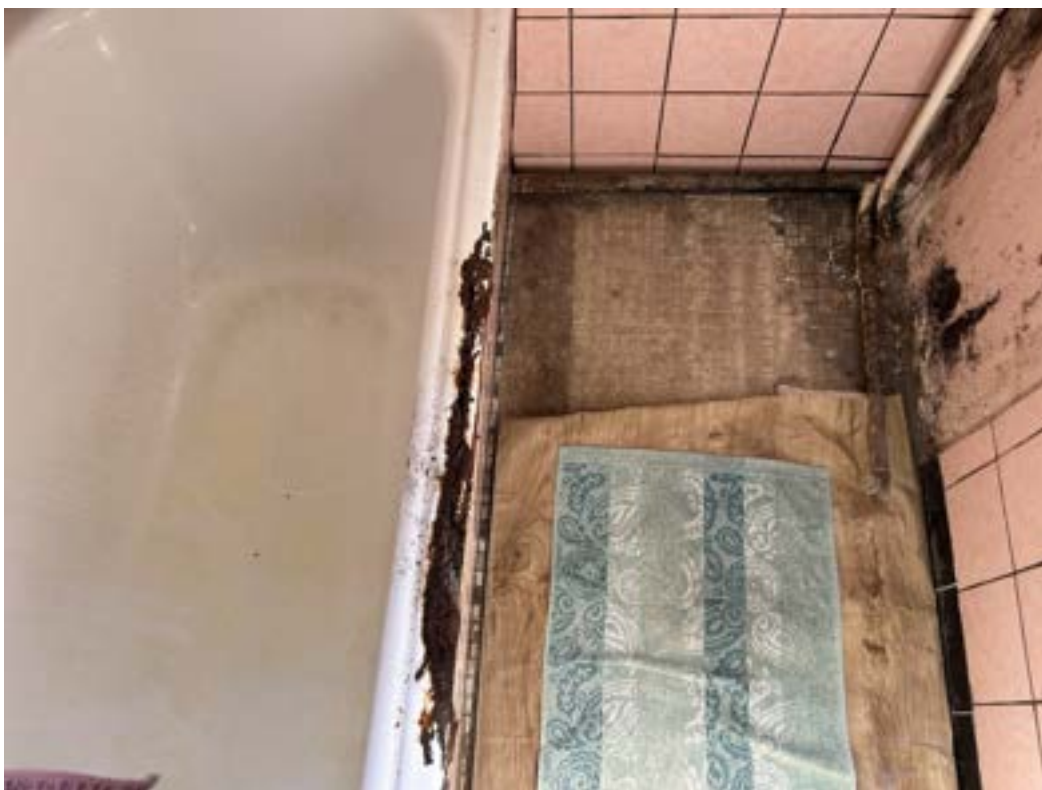
Anlage 5.8: Bild 8 Badezimmer Obergeschoss stark abgängig
