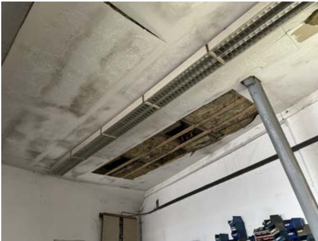
Anlage 5.15: Bild 15 Durchfeuchtung Deckenbereich in der Werkstatt
