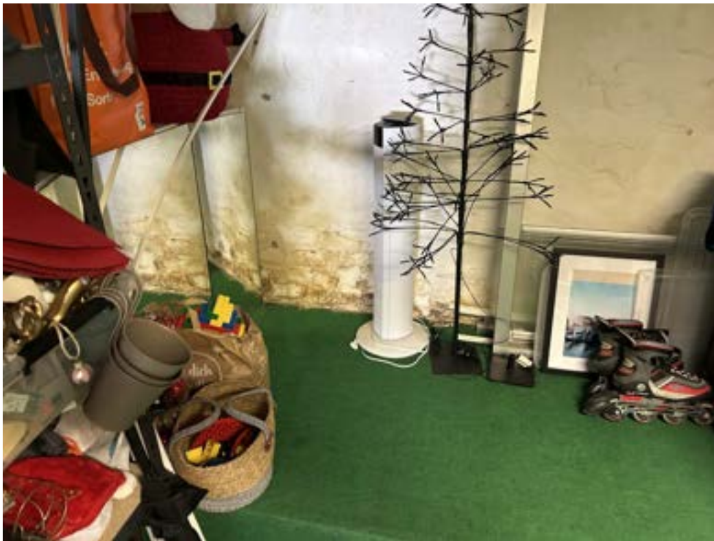
Anlage 5.9: Bild 9 Aufsteigende Feuchtigkeit im Erdgeschoss
