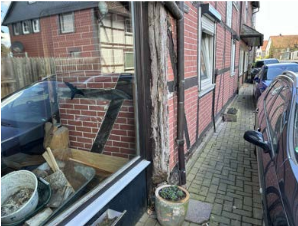
Anlage 5.13: Bild 13 Schäden am Fachwerk und Gefachen
