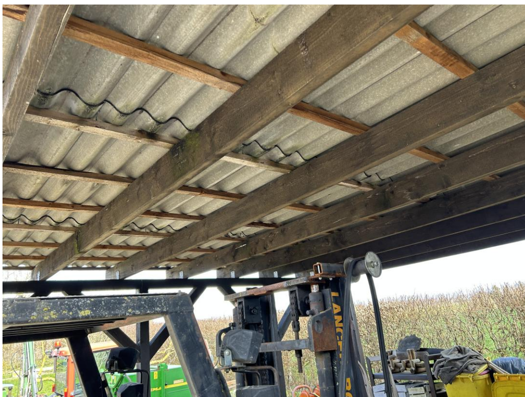
Anlage 5.2: Bild 2 Undichte Dacheindeckung des Unterstands
