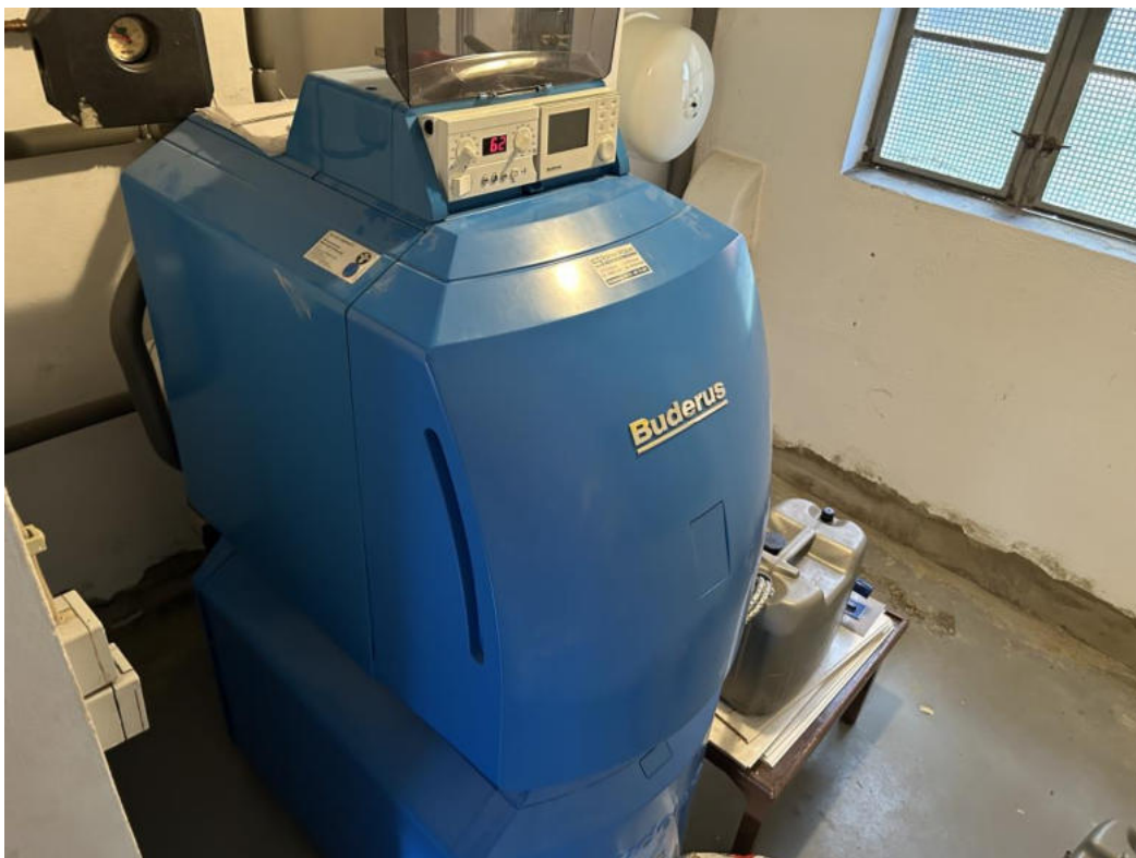
Anlage 5.12: Bild 12 Ölzentralheizung (Brennwertkessel)
