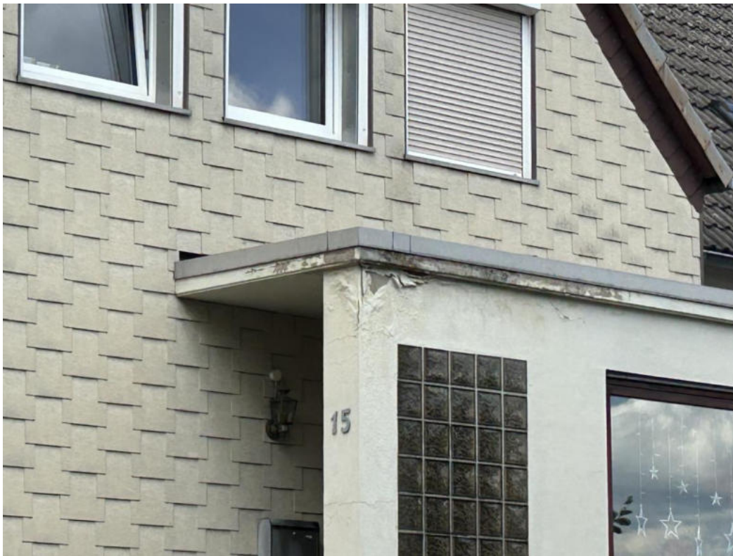
Anlage 5.13: Bild 13 Schäden Flachdachabdichtung Eingangsbereich
