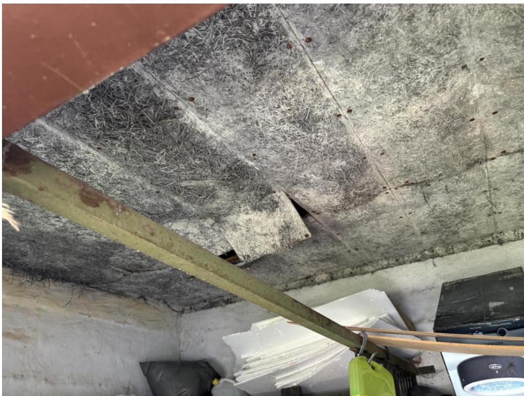
Anlage 5.14: Bild 14 Durchfeuchtung Dachbereich Nebengebäude
