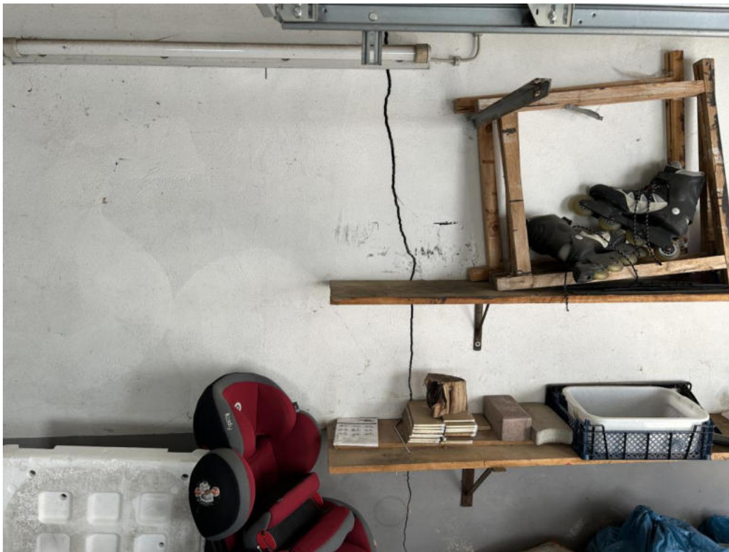
Anlage 5.15: Bild 15 Rissbildung im Nebengebäude
