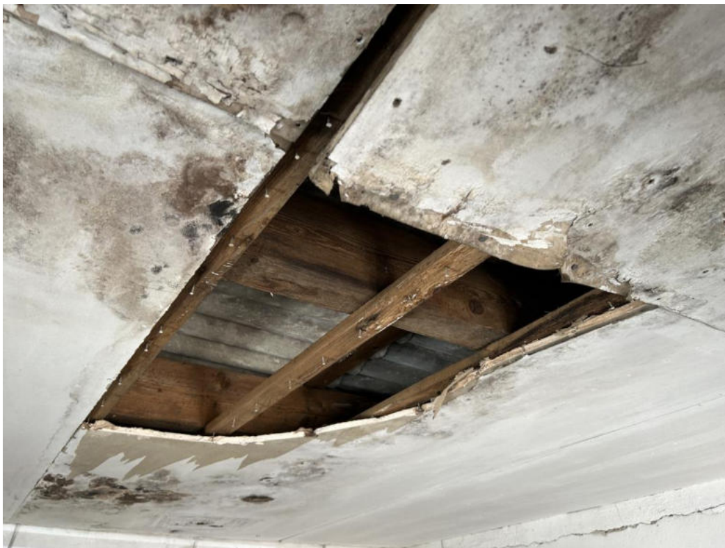
Anlage 5.16: Bild 16 Durchfeuchtung Dachbereich Nebengebäude
