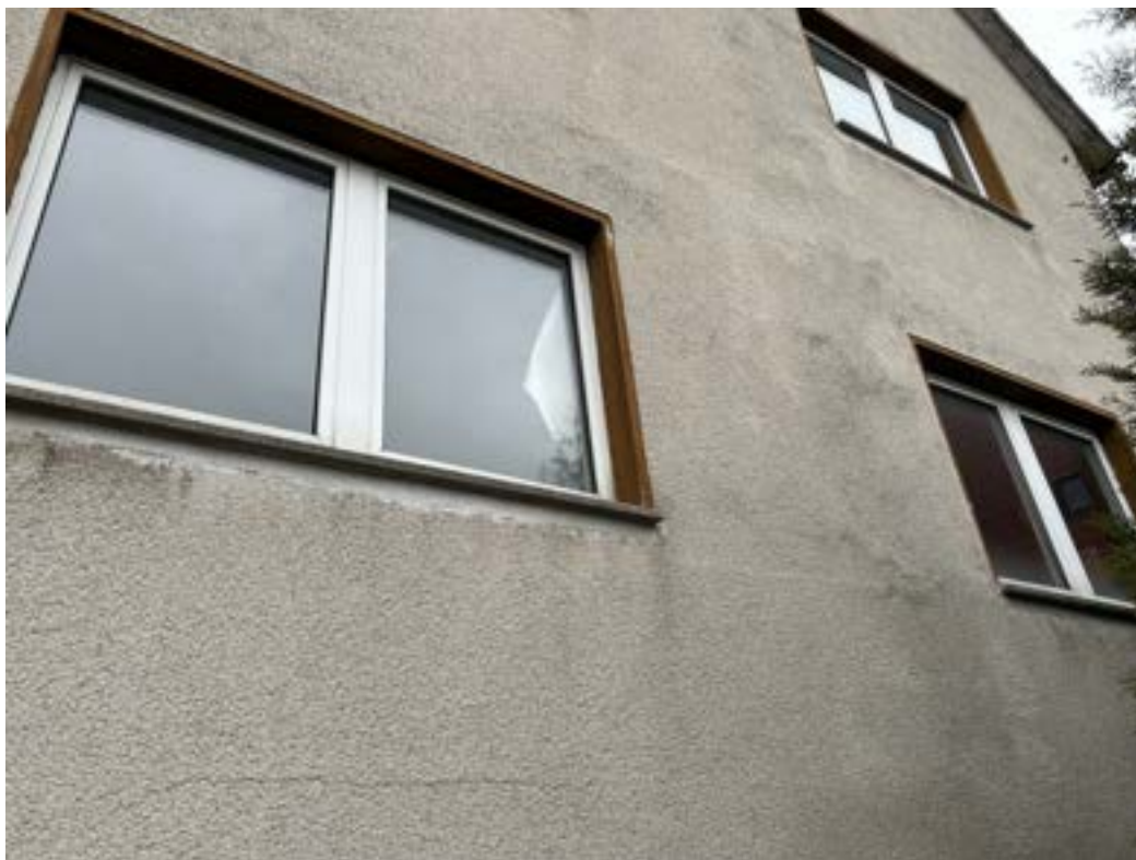
Anlage 5.10: Bild 10 Detail Fassade, erkennbar sind abgelöste Tapeten
