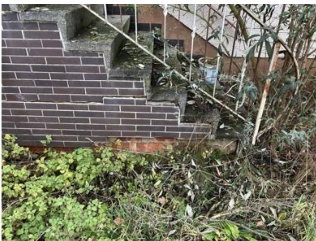
Anlage 5.8: Bild 8 Schäden an der Hauseingangstreppe
