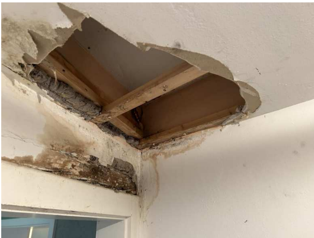
Anlage 5.14: Bild 14 Bauteilöffnung in Wohnung 1, Schäden an Unterdecke und Anstrich
