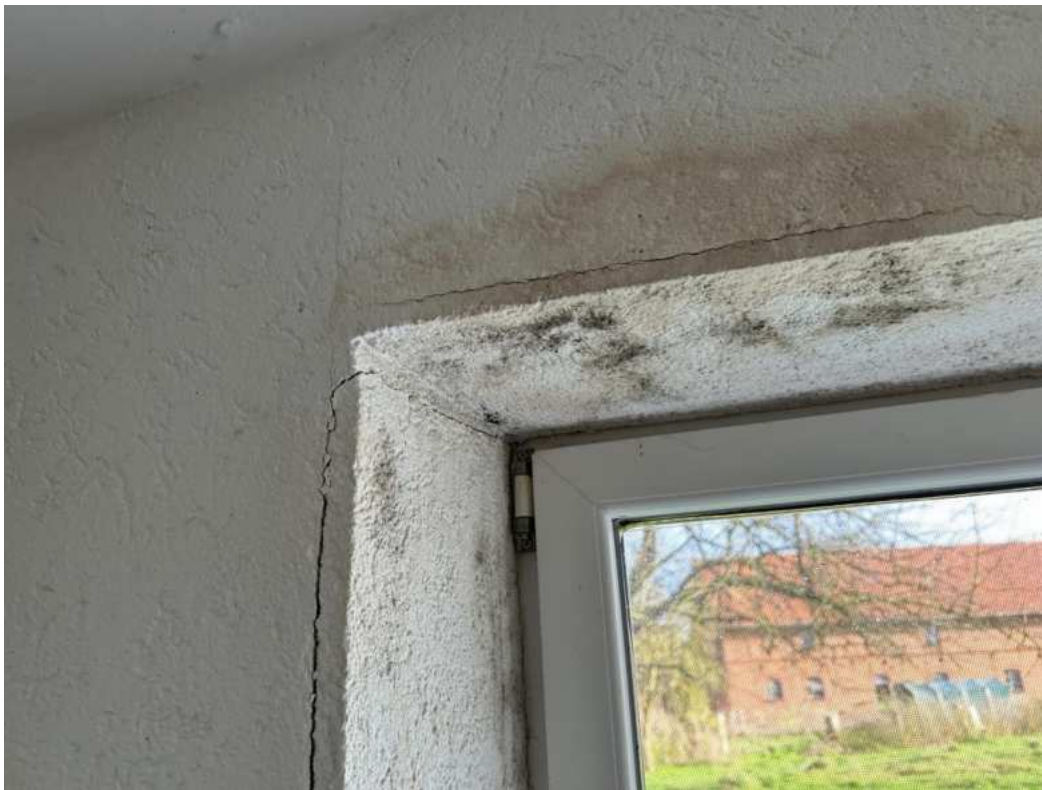
Anlage 5.13: Bild 13 Durchfeuchtung Außenwandbereich Wohnung 1
