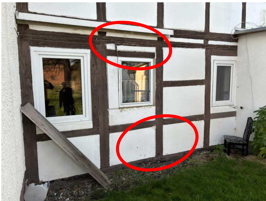
Anlage 5.15: Bild 15 Ansicht Fachwerkaußenwand mit Schäden am Holz und Putz
