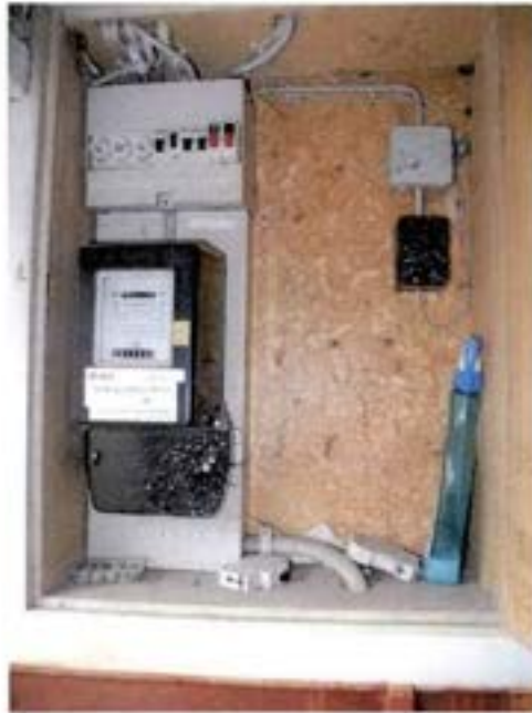
Bild 13: Ansicht Elektro-Unterverteilung im Erdgeschoss des Bewertungsobjekts
