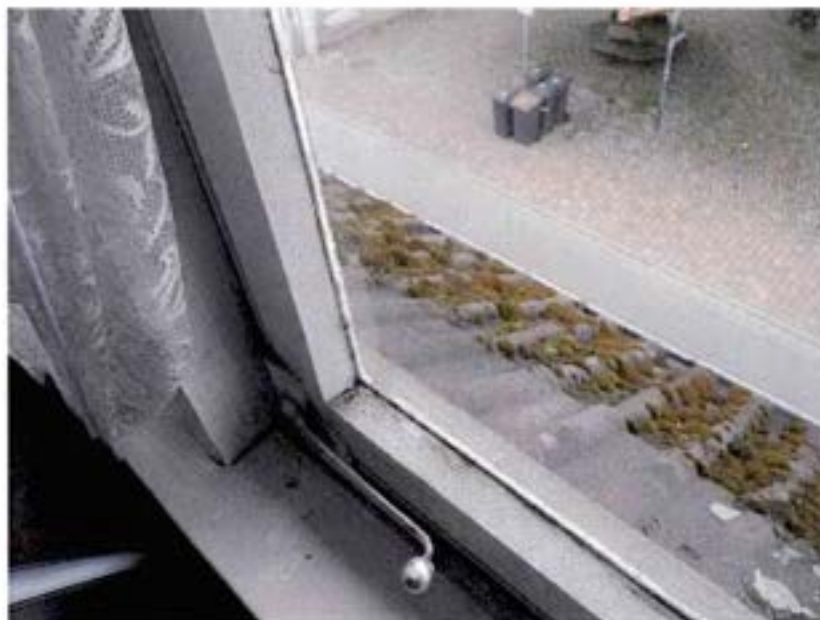
Bild 22: Fenster mit Einfachverglasung im Dachgeschoss des Bewertungsobjekts
