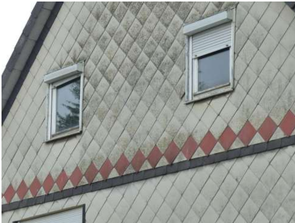
Bild 5: Mangelhafte Fenster/Mangelhafter Behang
